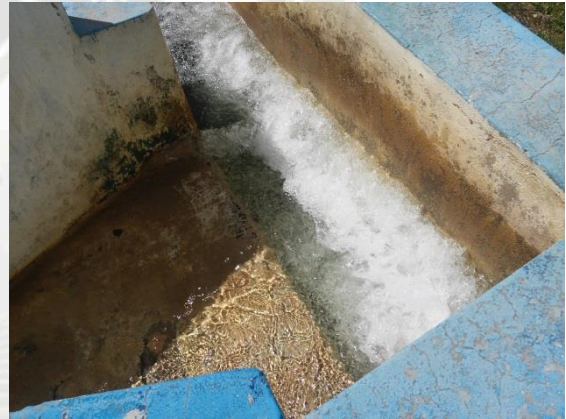
RESALTO IMPROVISADO GENERADO AL INICIO DEL FLOCULADOR
