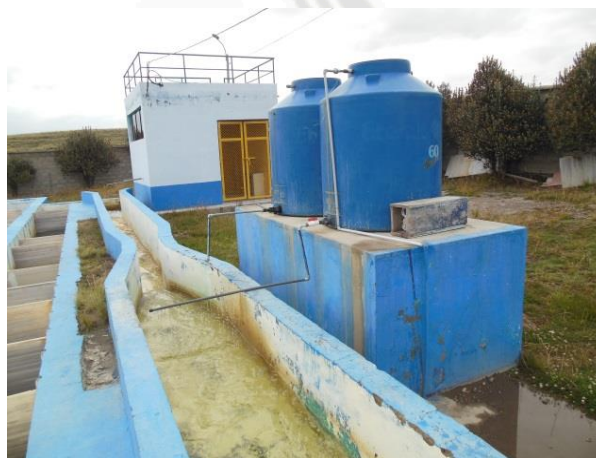
SISTEMA DE DOSIFICACIÓN DE LA PLANTA DE TRATAMIENTO
