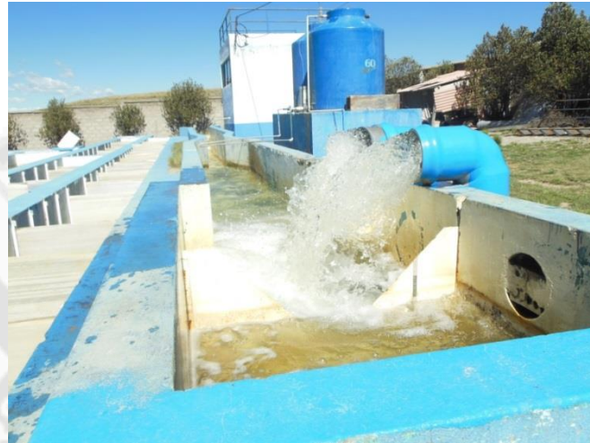
INGRESO DE AGUA A LA PLANTA DE TRATAMIENTO
