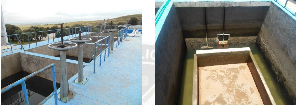
UNIDADES DE FILTRACIÓN RÁPIDA DE LECHO SIMPLE DE ARENA
