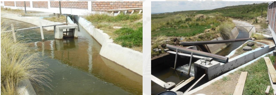
CANAL DE DERIVACIÓN PARA LA ESTACIÓN DE BOMBEO Y CAPTACIÓN IMPROVISADA DE LLUVIAS
