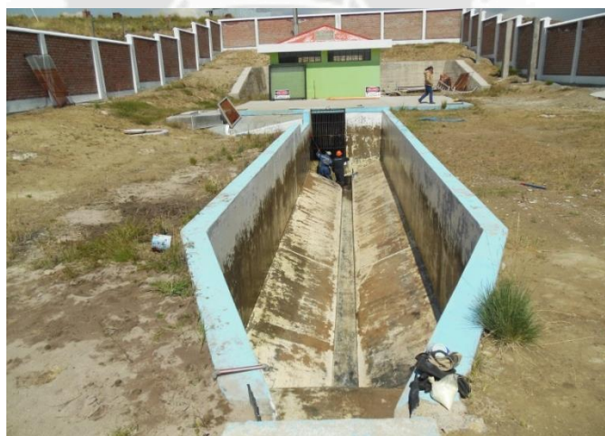
DESARENADOR DEL SISTEMA DE BOMBEO
