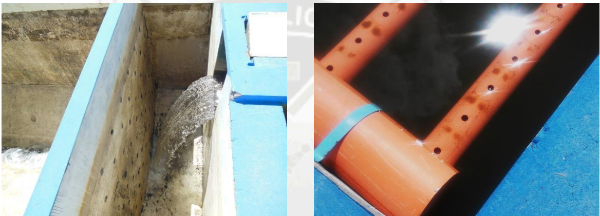
ESTRUCTURAS DE ENTRADA Y SALIDA DE LOS DECANTADORES. OBSÉRVESE LA ACUMULACIÓN DE FLÓCULOS A LA ORILLA DE LOS ORIFICIOS.
