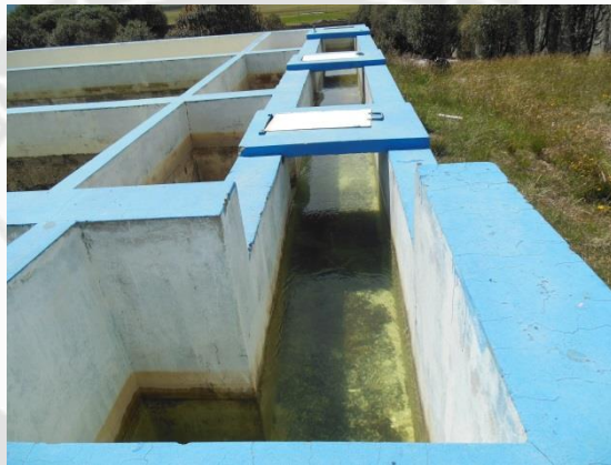
CANAL DE DISTRIBUCIÓN DE AGUA FLOCULADA
