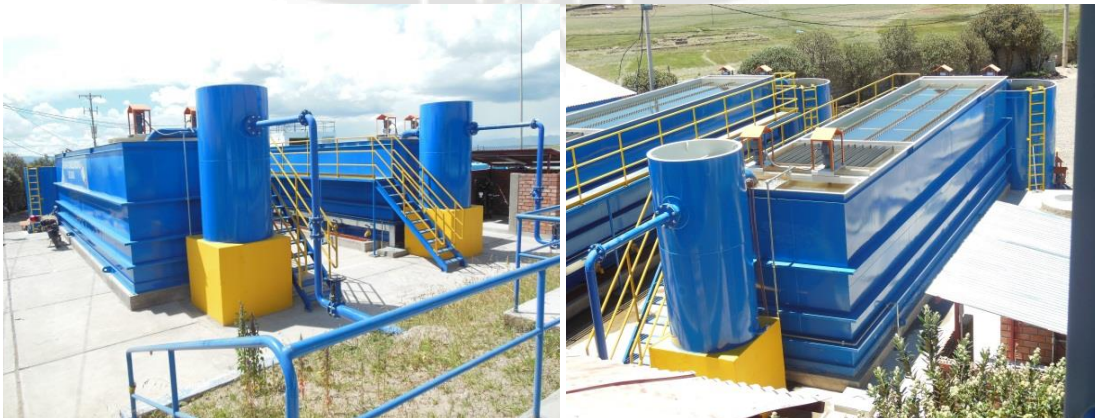
UNIDADES COMPACTAS DE TRATAMIENTO DE AGUA, QUE TRATAN LAS AGUAS PROVENIENTES DE HUAYLLUMAYO
