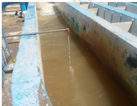
LA FORMA Y PUNTO DE APLICACIÓN DEL COAGULANTE NO ES EL ADECUADO
