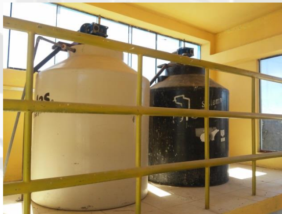
TANQUES DE SOLUCIÓN SIN UTILIZAR EN LA SALA DE DOSIFICACIÓN
