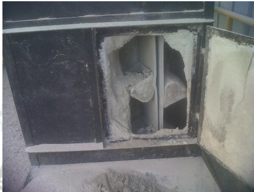
Imagen 4.6. Ducto de mineral
