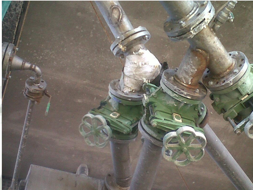
Imagen 4.9. Válvulas de descarga
