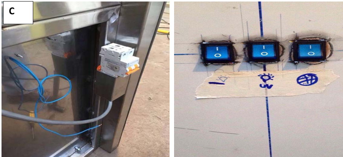
FOTOGRAFÍA 07. A,B,C,D: Instalaciones eléctricas con luz ultravioleta
