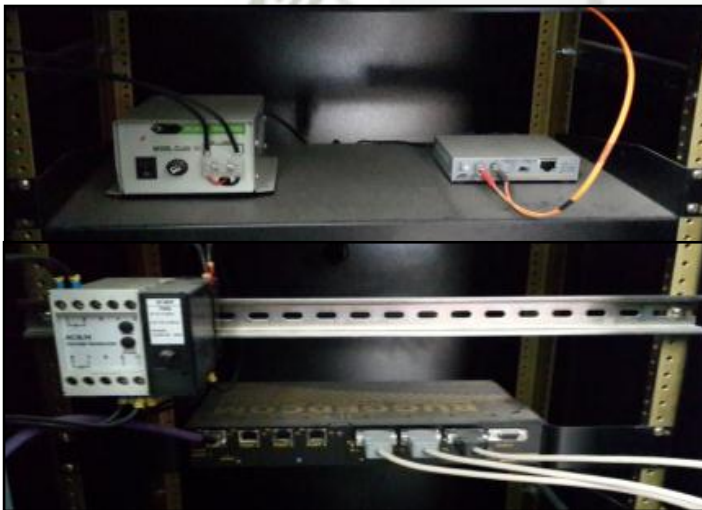
Figura 94. Tablero de comunicaciones de la SET Ocoña
