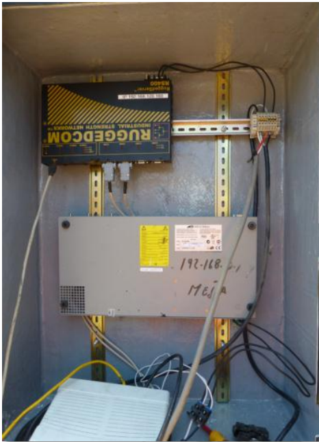
Figura 51. Tablero de comunicaciones de la SET Meja
