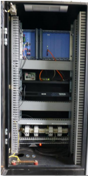
Figura 42. Tablero de control de la SET Agua Lima
