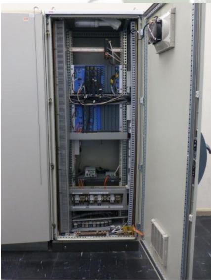
Figura 62. Tablero de control de la SET Chilina
