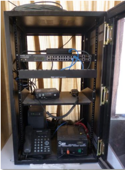
Figura 78. Tablero de comunicación de la SET Corire
