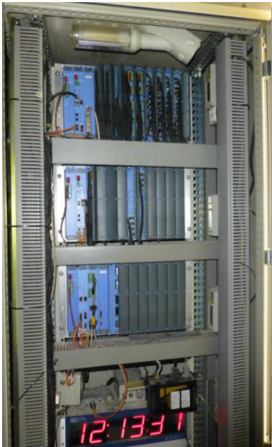
Figura 24. Tablero de control SET Socabaya
