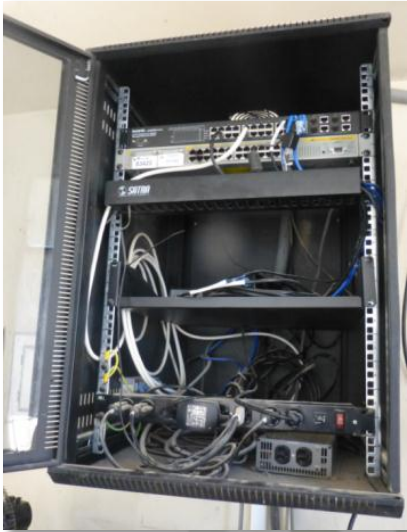
Figura 36. Tablero de comunicaciones de la SET El Cruce
