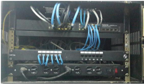
Figura 96. Tablero de comunicaciones de la SET Camaná
