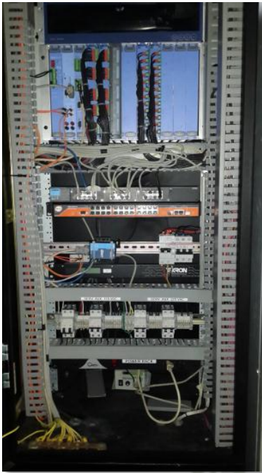
Figura 48. Tablero de control de la SET Mollendo
