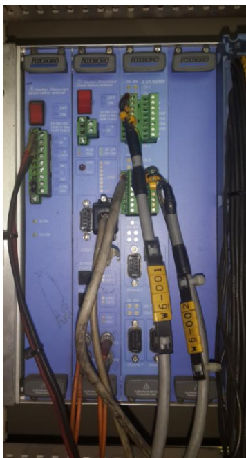
Figura 19. RTU FOXBORO SCD5200 de la SET Challapampa
