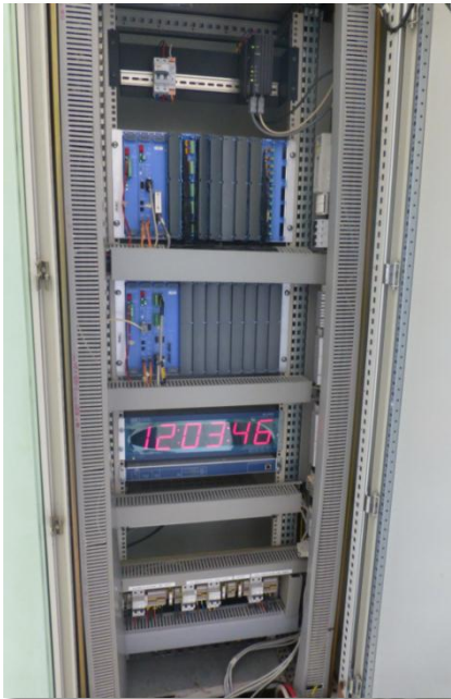
Figura 45. Tablero de control de la SET Base Islay
