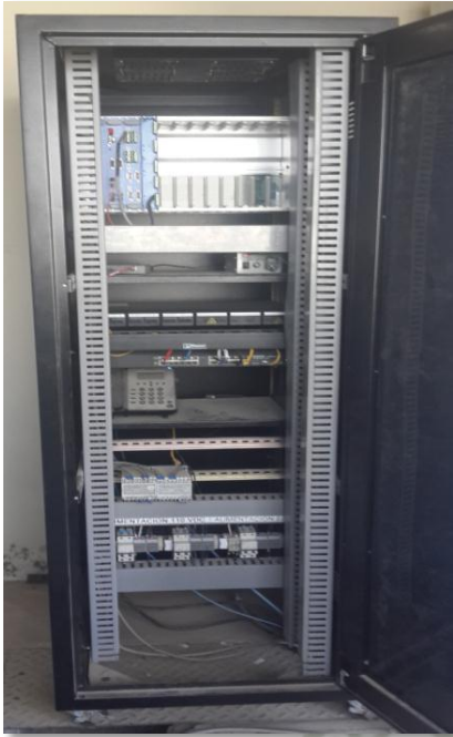
Figura 11. Tablero de control SET Alto Cayma
