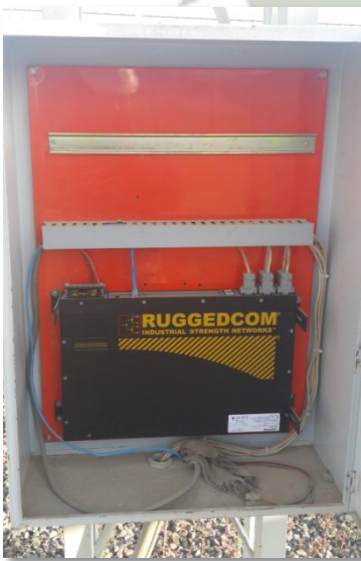
Figura 12. Switch Port Server SET Alto Cayma
