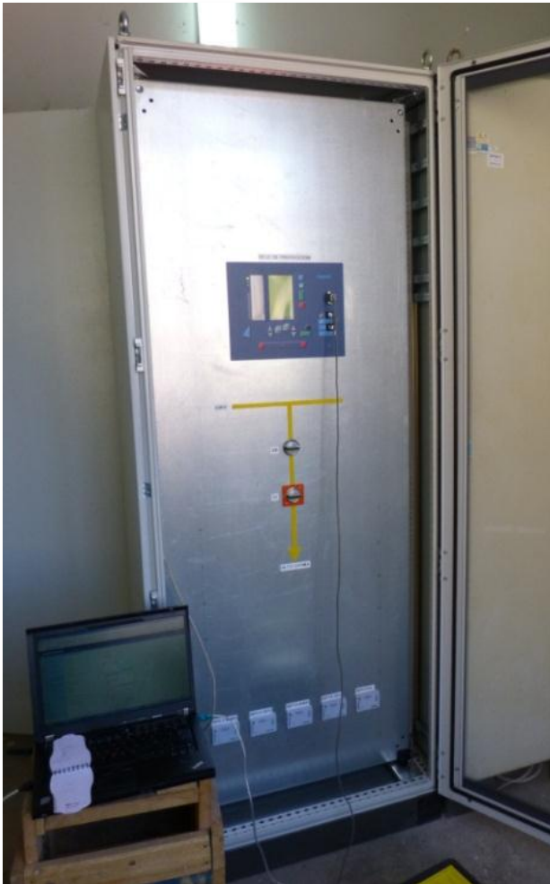
Figura 14. Tablero de control SET Charcani I
