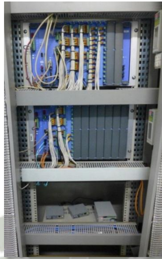
Figura 80. Tablero de control de la SET Majes
