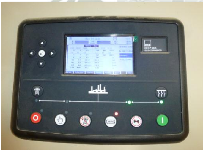
Figura 108. Controlador de grupo de grupo electrógeno
