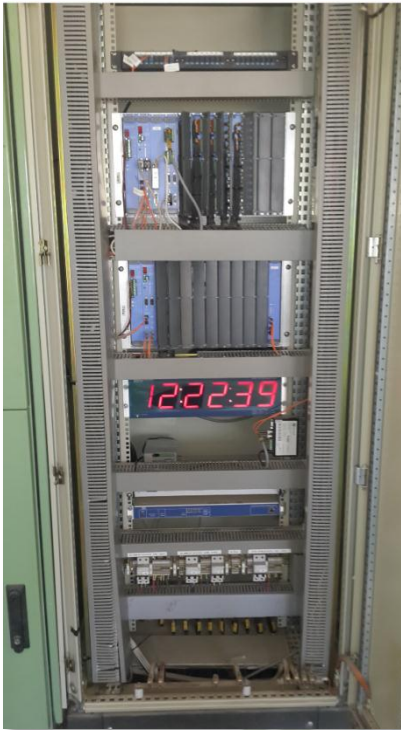
Figura 33. Tablero de control de la SET Repartición
