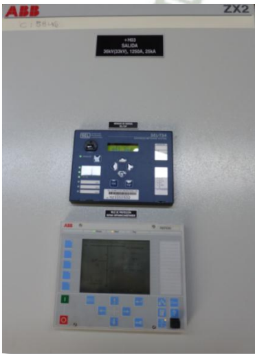
Figura 67. Relé de protección y medidor
