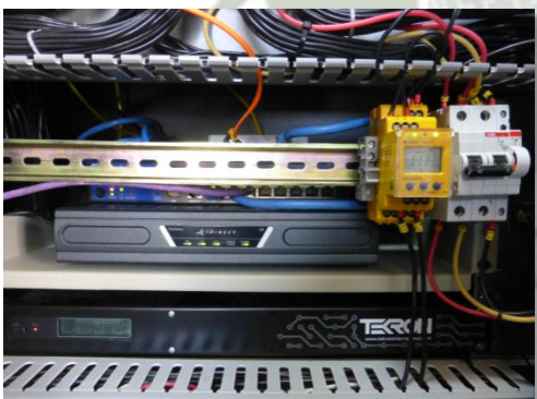
Figura 88. Tablero de comunicaciones de la SET Marcona
