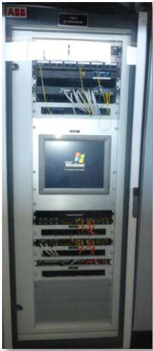
Figura 66. Tablero de comunicaciones de la SET Porongoche
