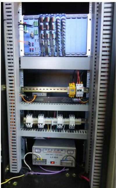
Figura 87. Tablero de control de la SET Marcona
