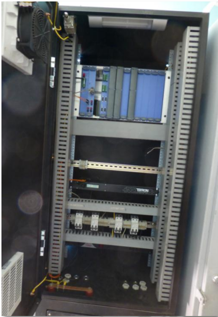
Figura 75. Tablero de control de la SET Chuquibamba
