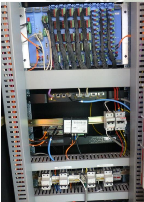
Figura 97. Tablero de control de la SET Camaná
