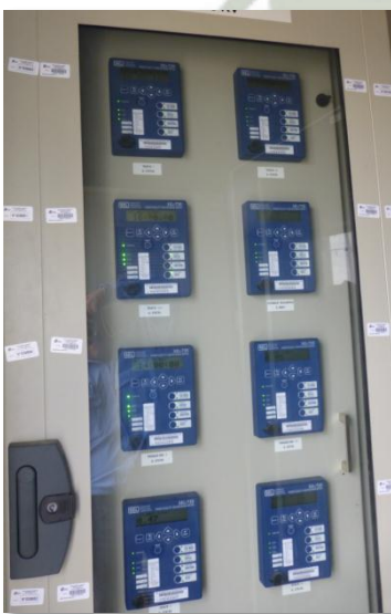
Figura 25. Tablero de medidores
