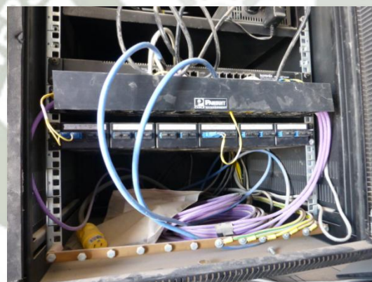
Figura 17. Tablero de comunicaciones SET Cono Norte
