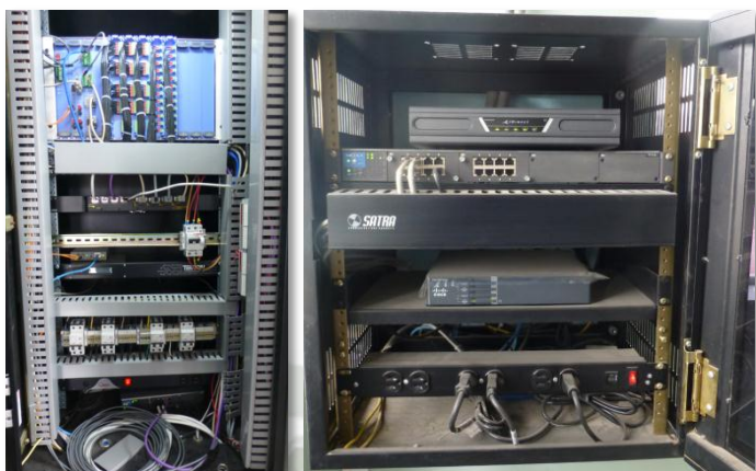
Figura 85. Tablero de control y de comunicación de la SET Bella Unión
