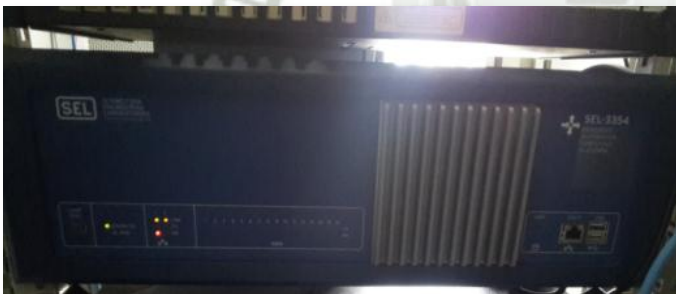
Figura 37. RTU SEL3354 Parque Industrial
