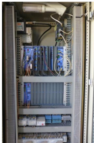
Figura 16. Tablero de control SET Cono Norte
