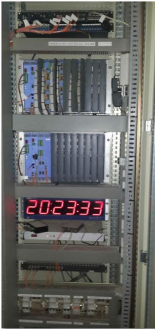
Figura 61. Tablero de control de la SET Chilina
