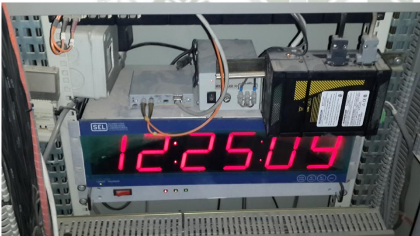
Figura 28. Reloj GPS de la SET Parque Industrial 10kV
