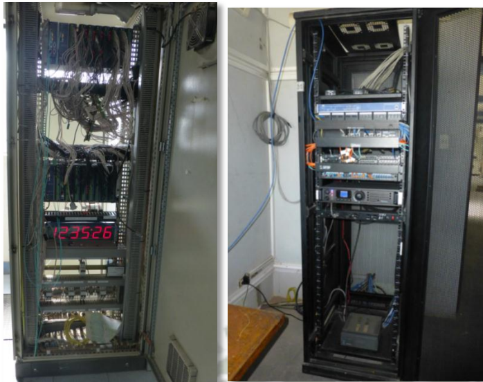
Figura 64. Tablero de control y comunicaciones de la SET Jesús
