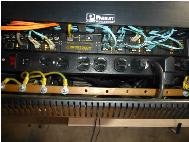
Figura 22. Tablero de comunicaciones SET San Lázaro
