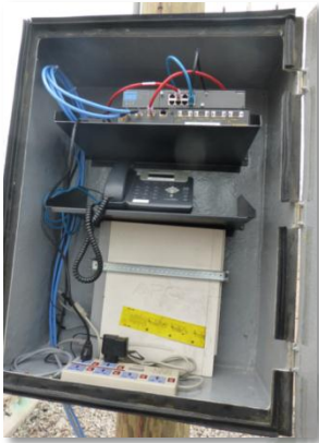
Figura 99. Tablero de comunicación de la SET Jahuay
