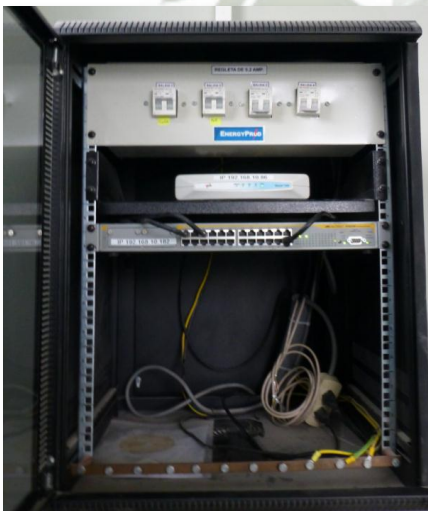
Figura 43. Tablero de comunicaciones de la SET Agua Lima
