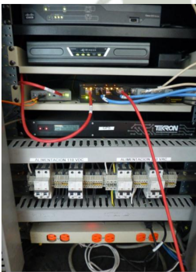
Figura 76. Tablero de comunicaciones de la SET Chuquibamba
