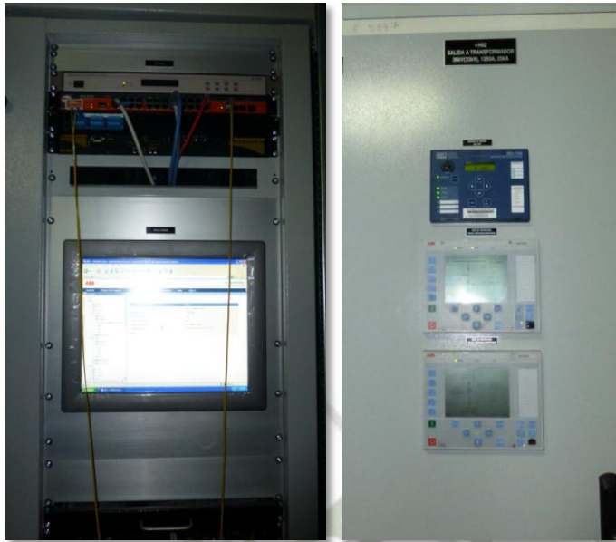
Figura 69. Tablero HMI de la SET Parque Lambramani
