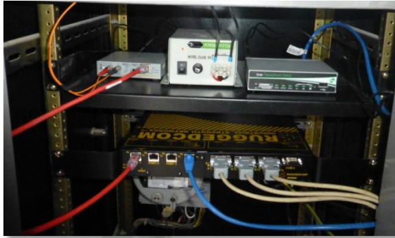
Figura 90. Tablero de comunicaciones de la SET Caraveli
