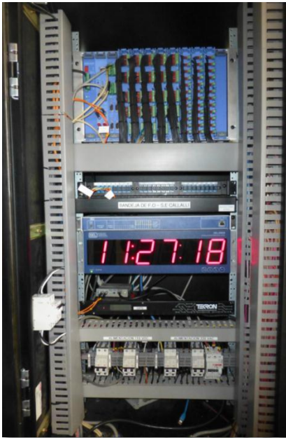
Figura 102. Tablero de control de la SET Callalli
