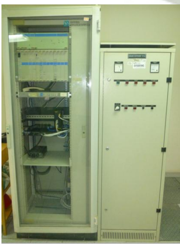
Figura 34. Tablero de comunicaciones de la SET Repartición
