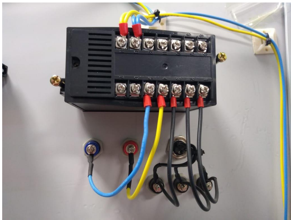
Figura 25. Borneras de alimentación. Fuente: Elaboración propia
