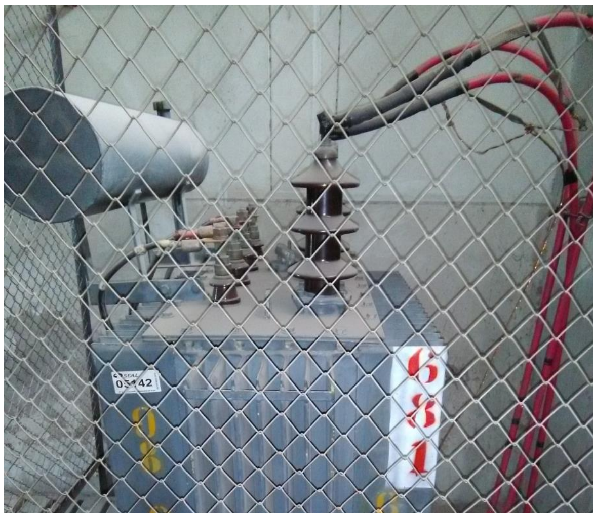
FotoN°6: Transformador en subestación tipo Caseta
