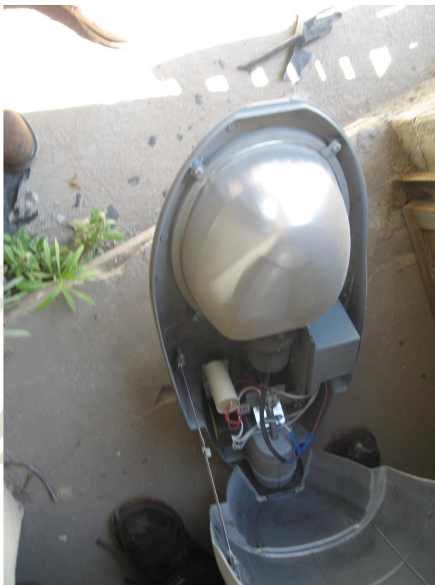
Foto N°3: Equipo de Alumbrado Público
