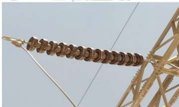
Figura 8 Contaminación excesiva en cadena de anclaje de aisladores cerámicos
