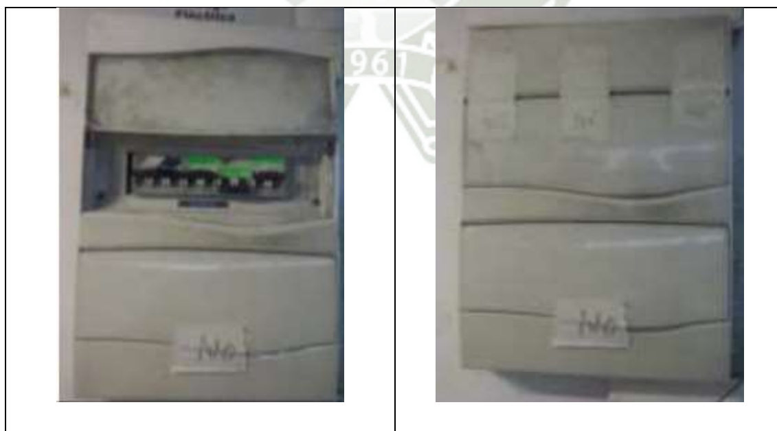
Figura 41 Tablero de distribución TCA
