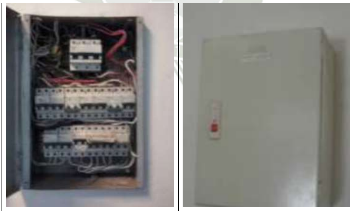
Figura 39 Tablero eléctrico de distribución del caso estudio
