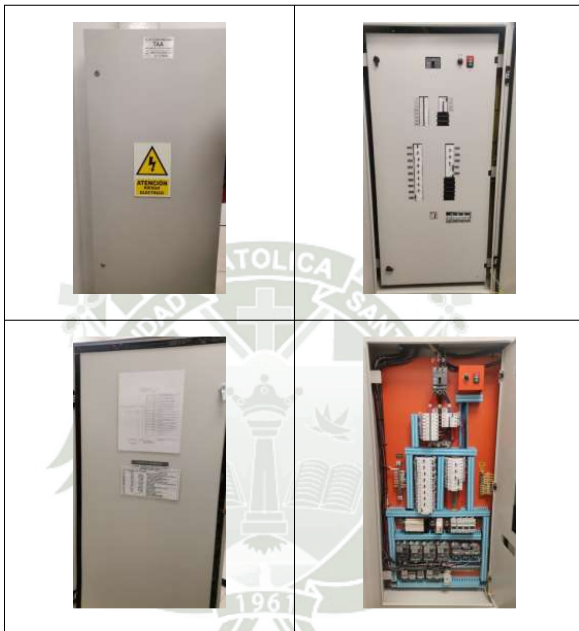
Figura 73 Estado final del Tablero TAA
