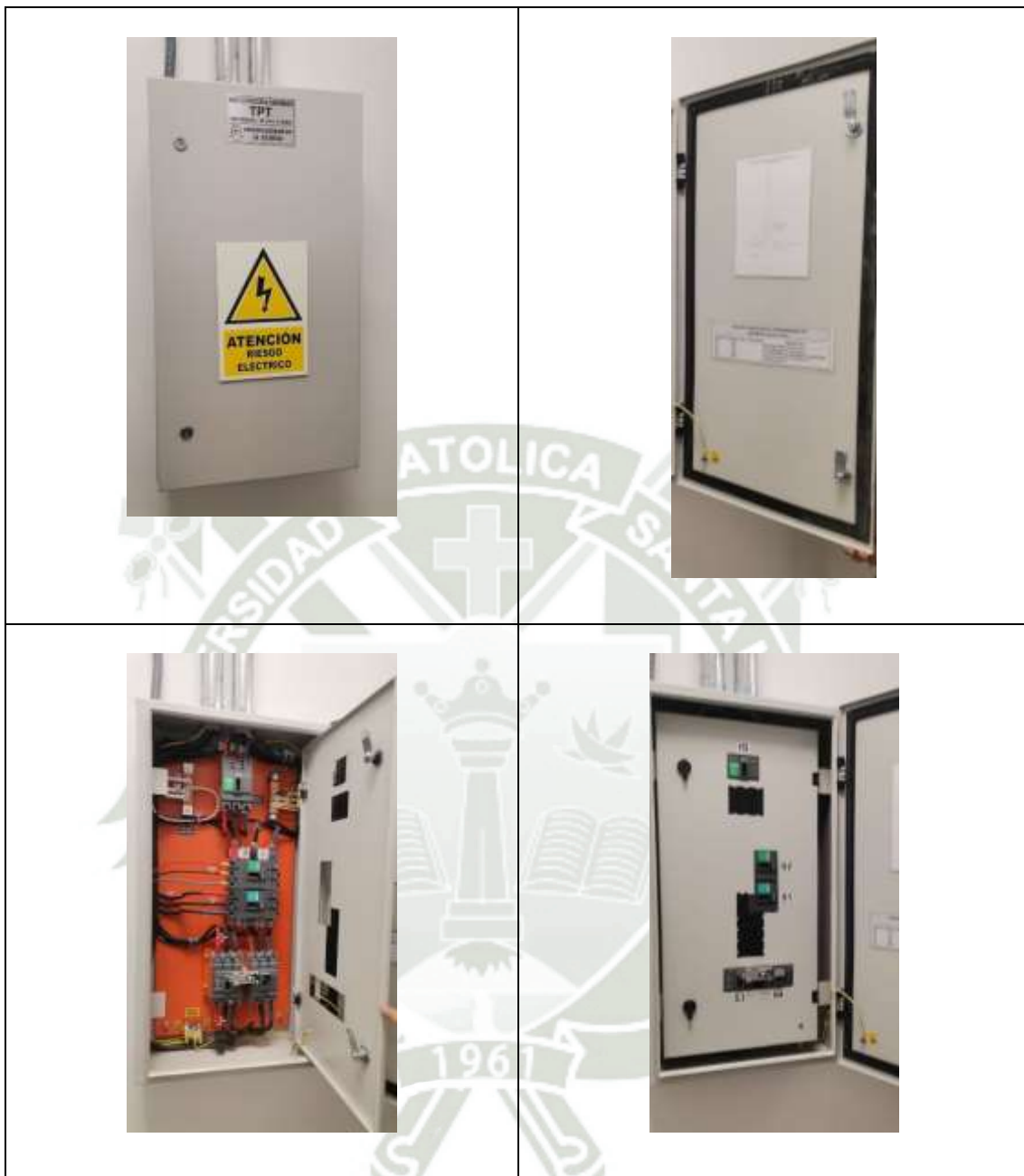
Figura 74 Estado final del Tablero TPT
