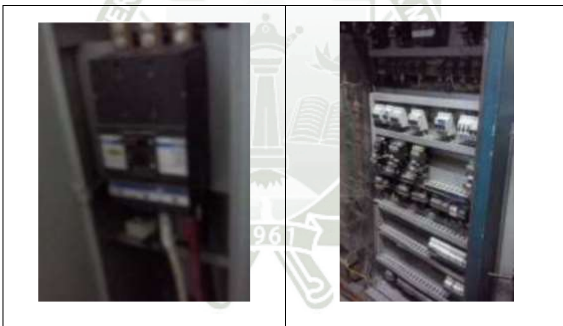
Figura 38 Tablero eléctrico general del caso estudio
