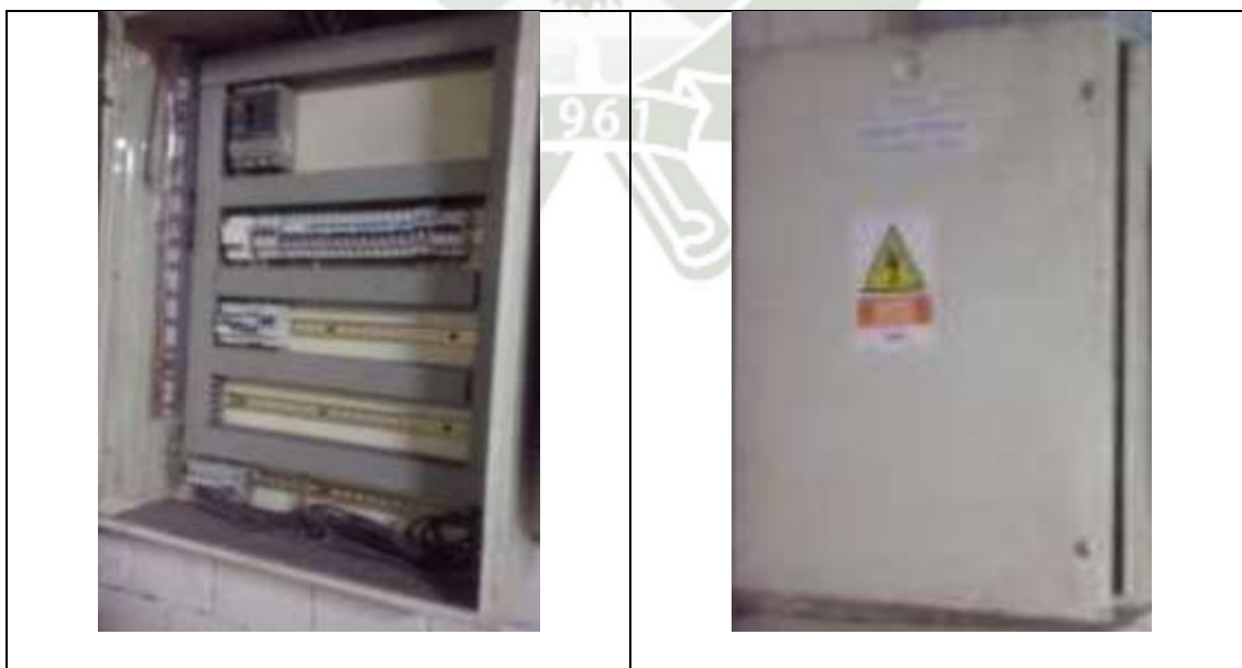
Figura 40 Observaciones encontradas Tablero de distribución TAA
