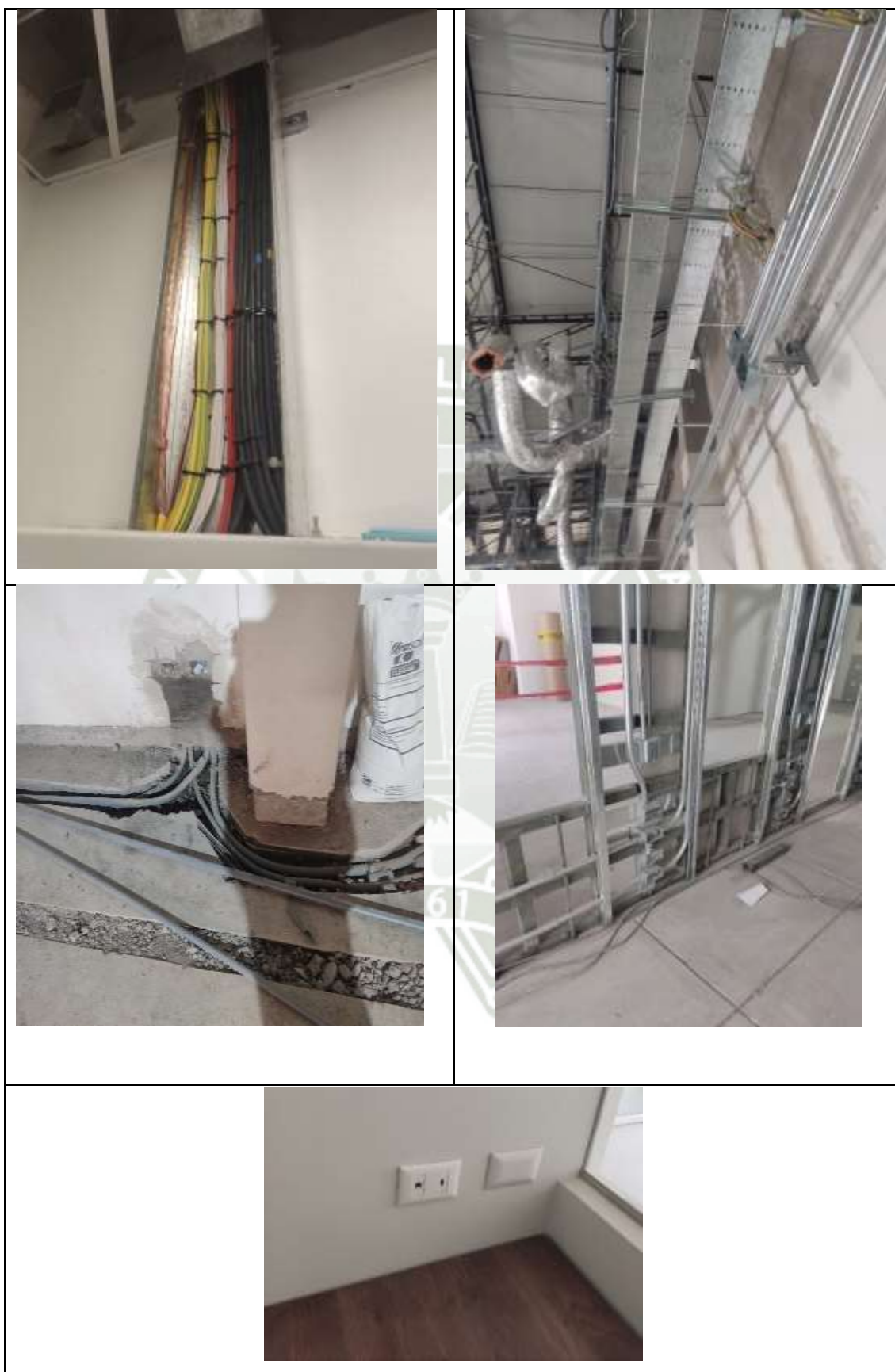
Figura 78 Ductos, bandejas y cajas de la instalación eléctrica
