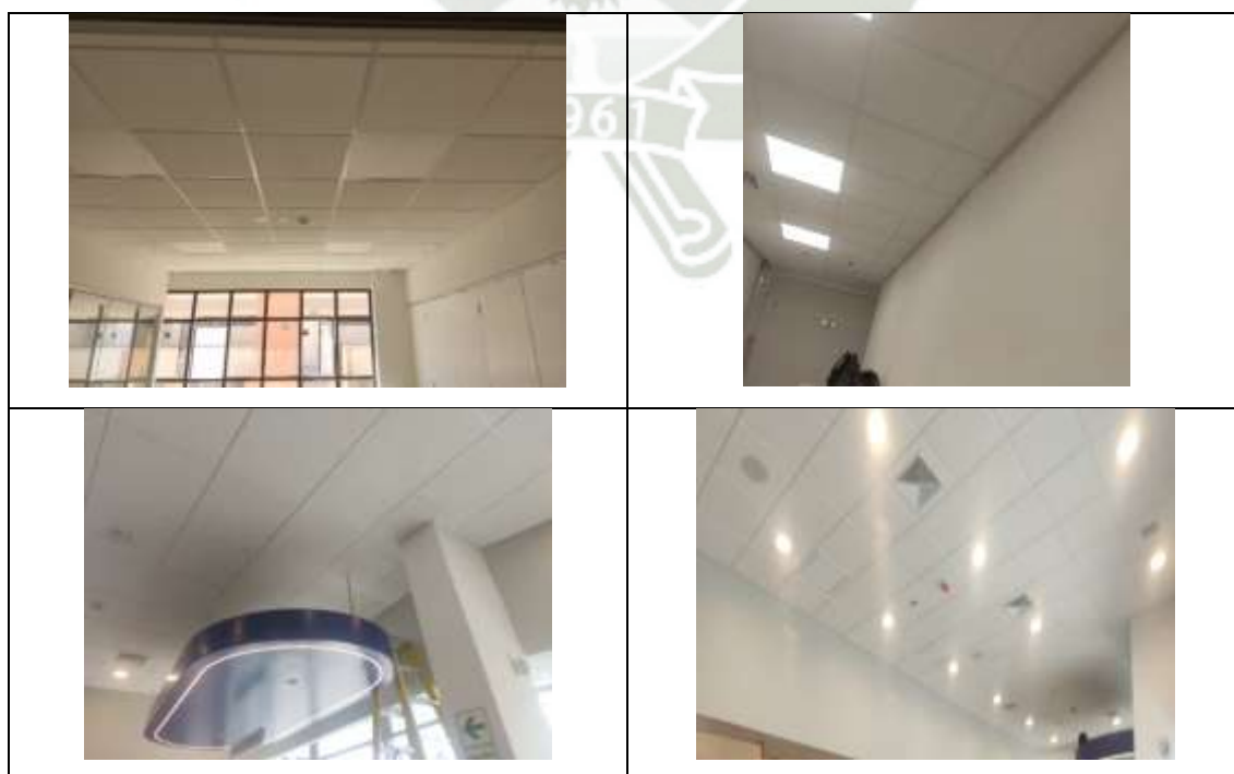
Figura 79 Implementación de luminarias nuevas
