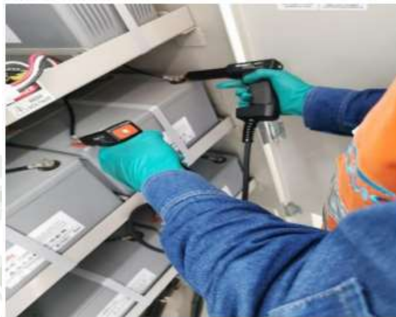
Figura 11 Medición de impedancia de baterías
