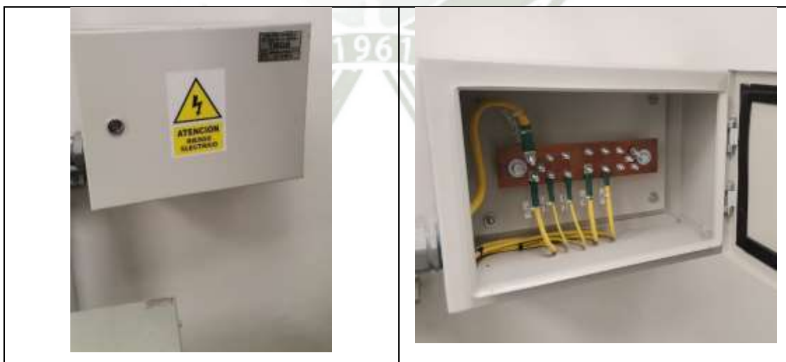
Figura 82 Caja equipotencial para distribución de la línea de tierra a todos los subtablero, señalización de posos a tierra, mantenimiento de pozos
