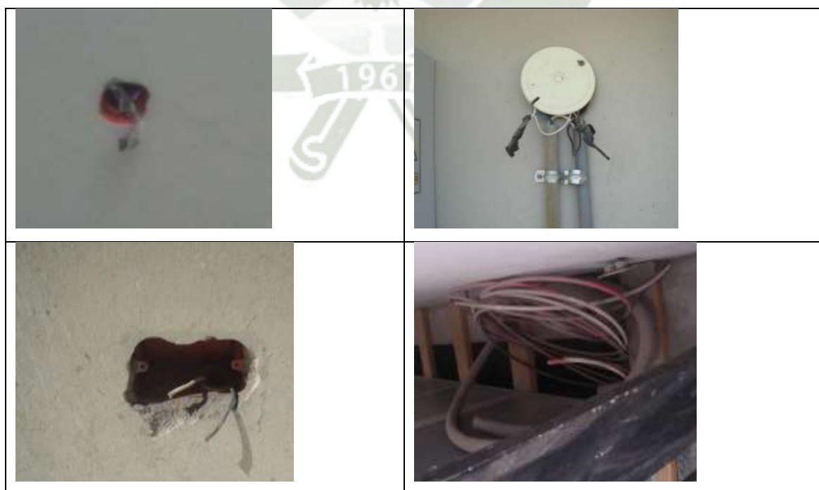
Figura 45 Cableado de las instalaciones eléctricas
