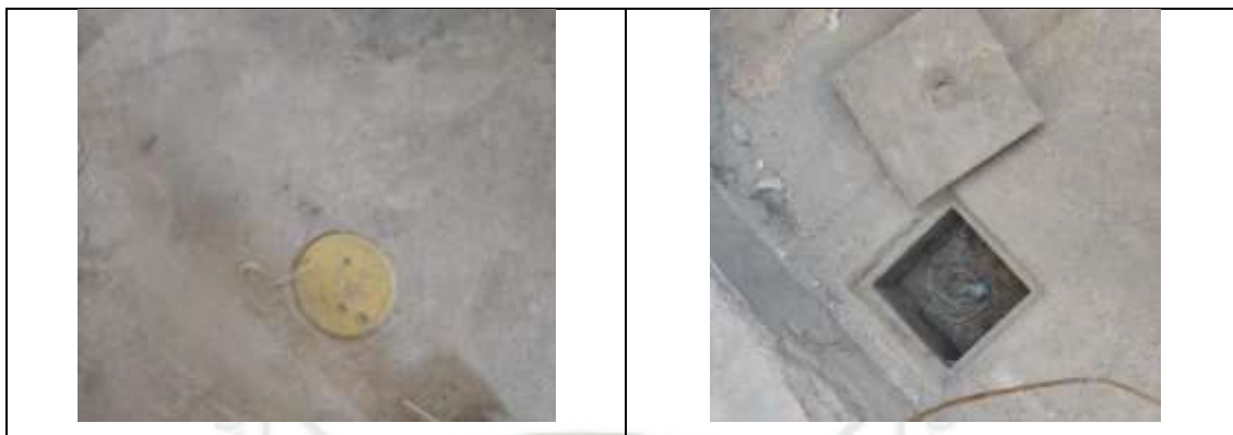
Figura 49 Sistemas puesta a tierra de las instalaciones eléctricas
