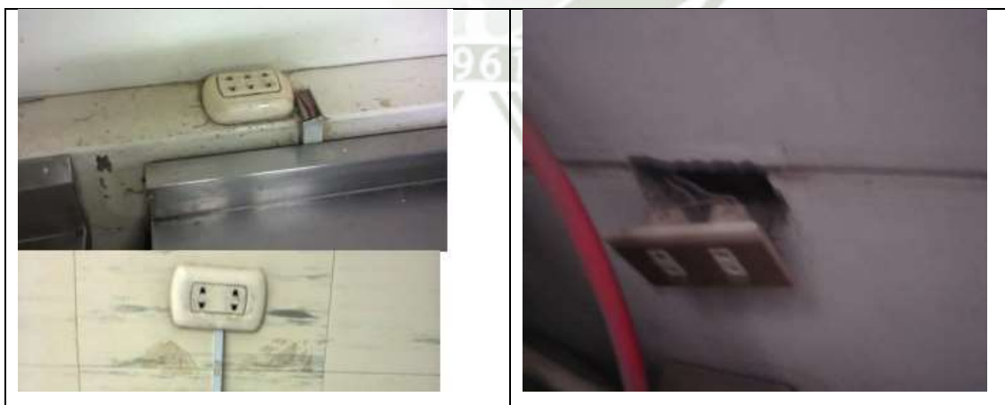
Figura 47 Tomacorrientes de las instalaciones eléctricas
