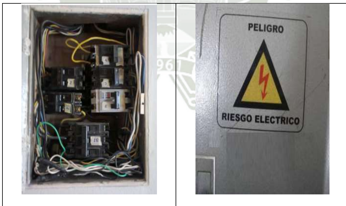
Figura 42 Tablero de distribución TPT
