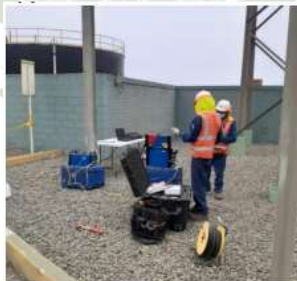
Figura 15 Medición de tensiones de toque y paso
