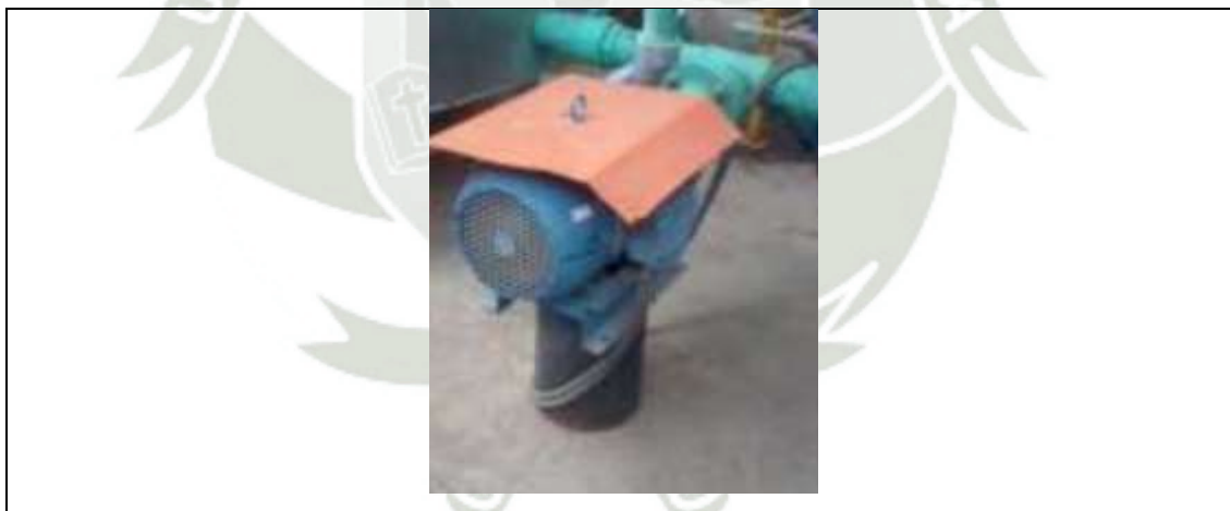
Figura 48 Equipos eléctricos de las instalaciones eléctricas, electrobombas
