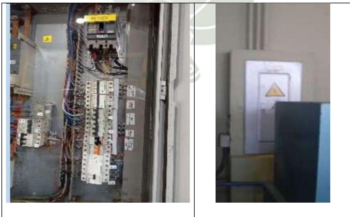
Figura 43 Tablero de distribución TTP
