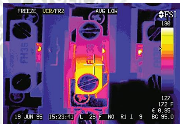
Figura 32 - Calentamiento excesivo en clip de conexión
