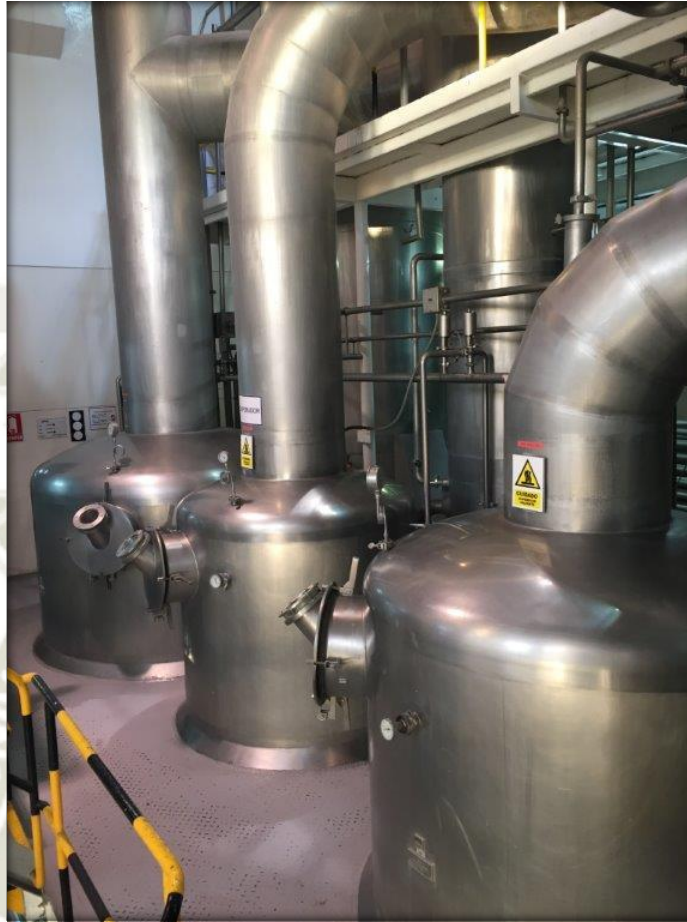
Fotografía de Evaporador de tres efectos
