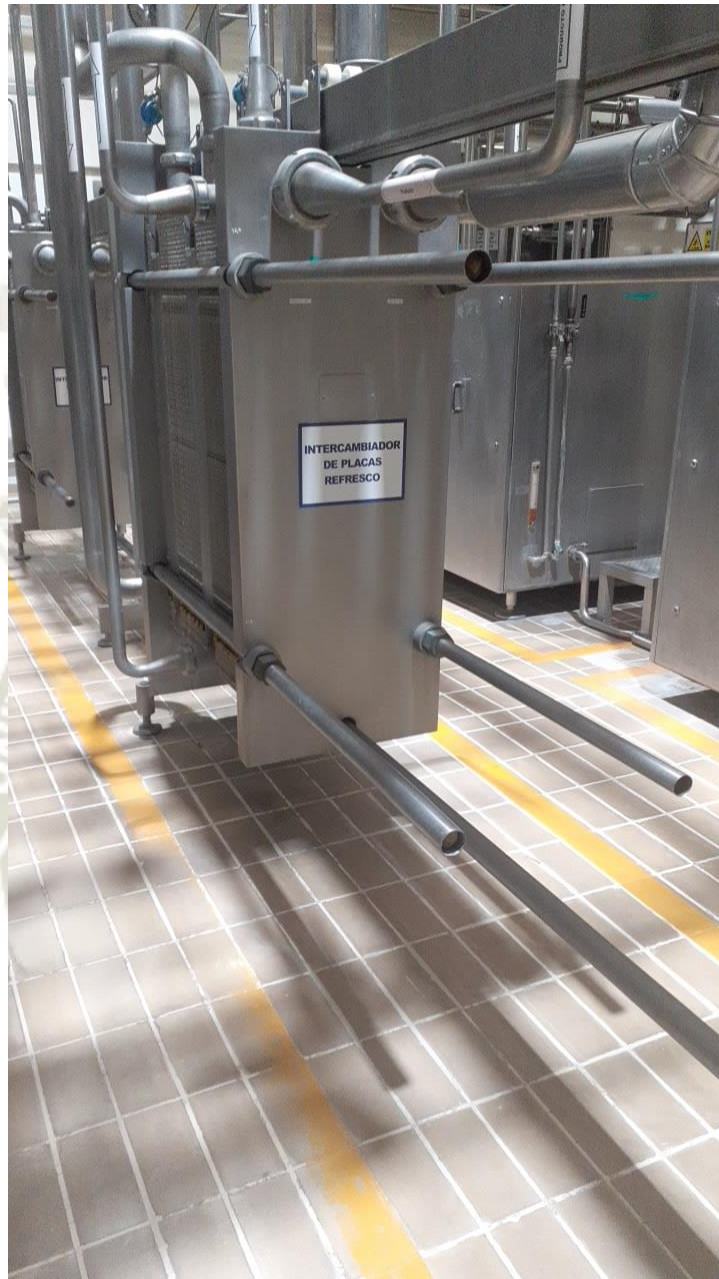
Figura 49. Fotografía de Intercambiador de placas de refresco
