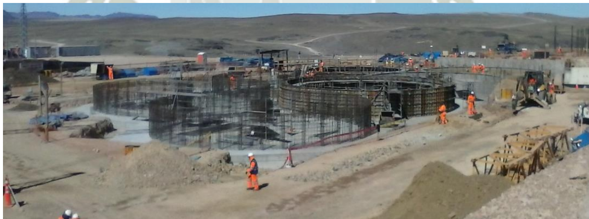
Panorámica del área de Lixiviación Fuente: Elaboración Propia.
