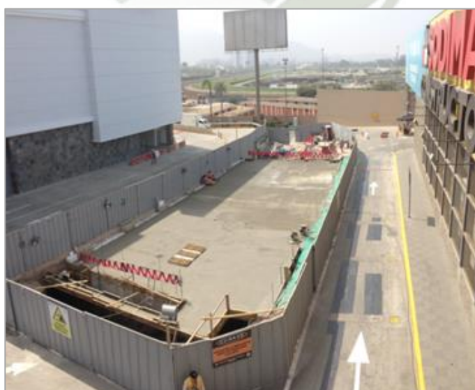
Figura 11: Proyecto “Estación de Bombeo y Cisterna – CC Jockey Plaza” (WESCON SAC) – Año: 2016 Fuente: Elaboración propia
