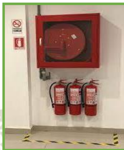
Figura 65. Ejemplo de demarcación para extintores
