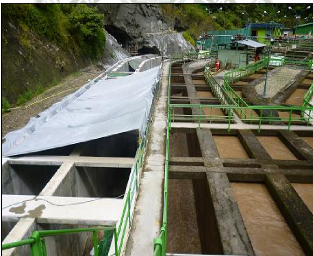
Canales de Alimentación - CHMP
