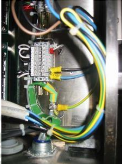
Fig. 2.10 Punto de unión de conductores de puesta a tierra en tablero.
