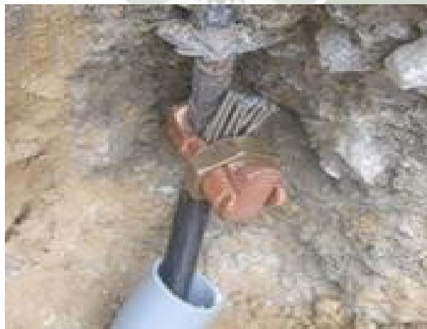
Fig. 4.10 .- Tipo de Cable para Conexión a Masas
