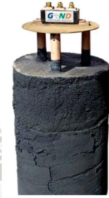
Fig. 3.4 Detalle del conjunto de puesta a tierra estructural
