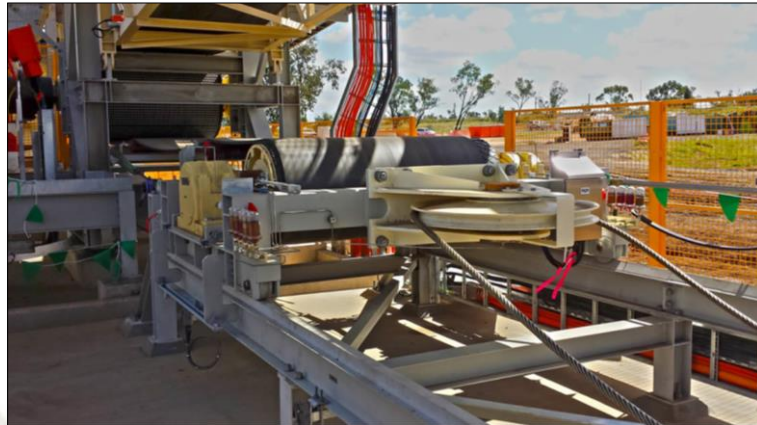
Figura 20 Winche de tensión en una faja transportadora
