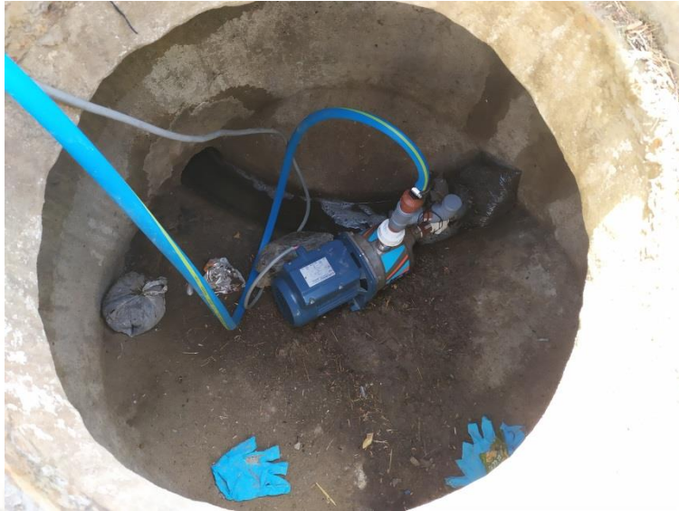
Figura 31. Bombeo de agua residual hacia el sistema
