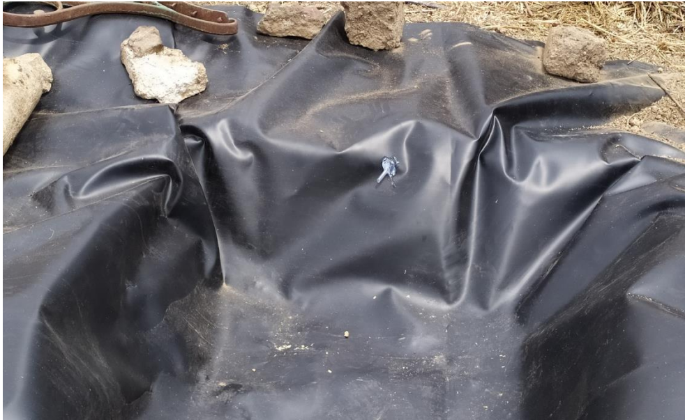
Figura 35. Laguna revestida de geomembrana
