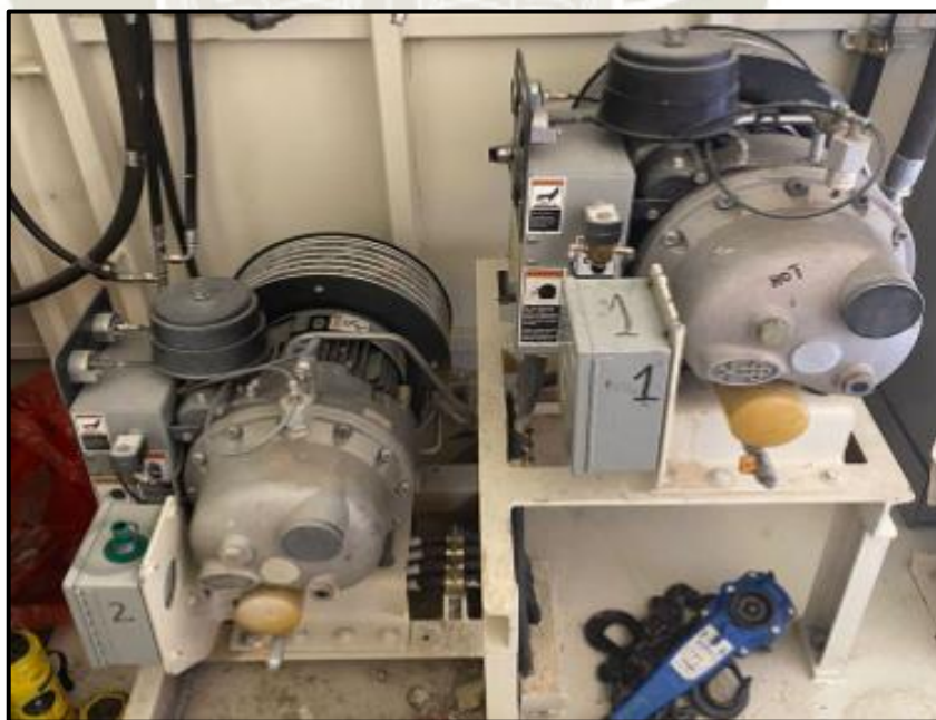
Figura 84 - Nuevo compresor dual de aire Sullair ES-6
