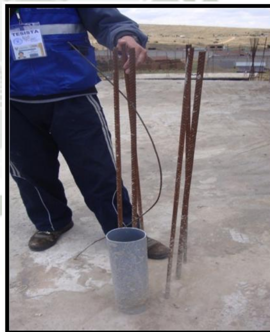
Figura 46. Estado de acero deplorable en losa de techo
