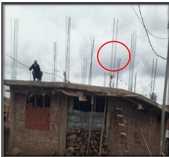
Fig. 88. Aceros expuestos y desprotegidos
