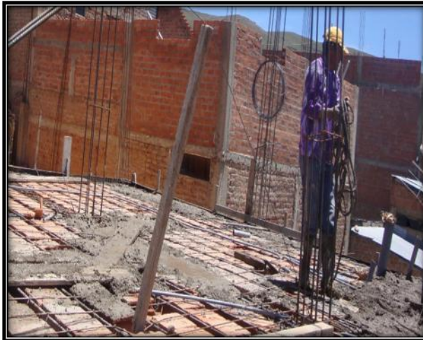
Fig. 152. Concreto colocado de manera desordenada
