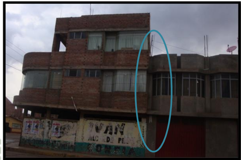
Figura 48. El 100% de las viviendas evaluadas no presentan junta de separación sísmica
