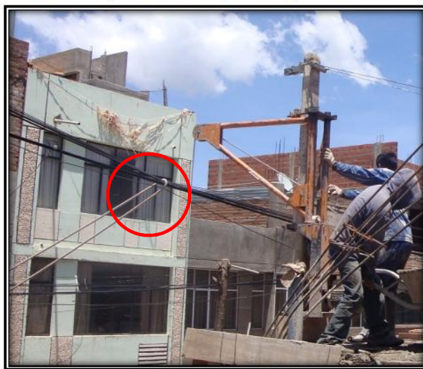
Fig. 183. Cables eléctricos sostenidos con una sog
