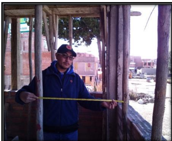
Fig. 112. Puntales colocados indistintamente
