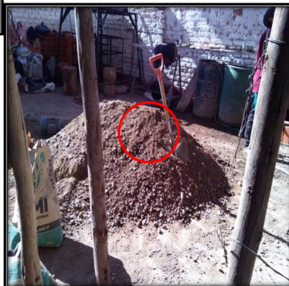
Fig. 71. Presencia de polvo y tierra en los Agregados
