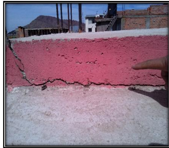
Fig. 140. Grieta por efecto de junta fría
