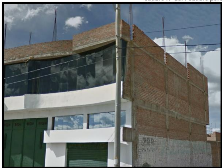
Figura 43. Vivienda invadida con alto grado de eflorescencia
