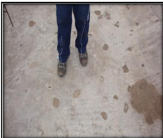
Fig. 104. Losa descascarada por acción del congelamiento
