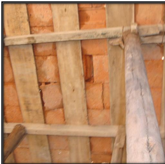
Fig. 167. Alineamiento inadecuado y unidades deterioradas
