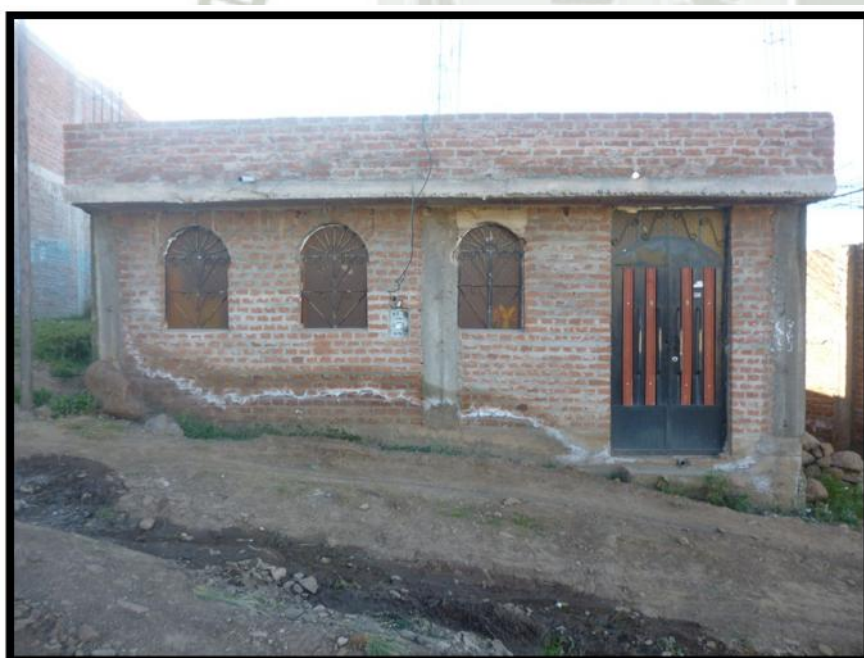
Figura 62. Vivienda que presenta problemas de filtración de agua y desnivel en el terreno.
