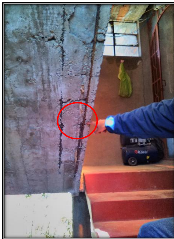
Fig. 86-b. Acero expuesto en la grada
