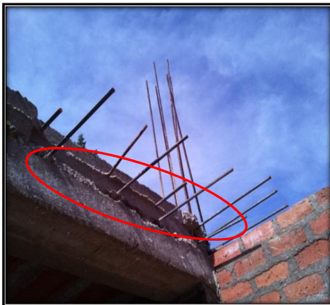
Fig. 141. Junta fría en la unión viga-losa
