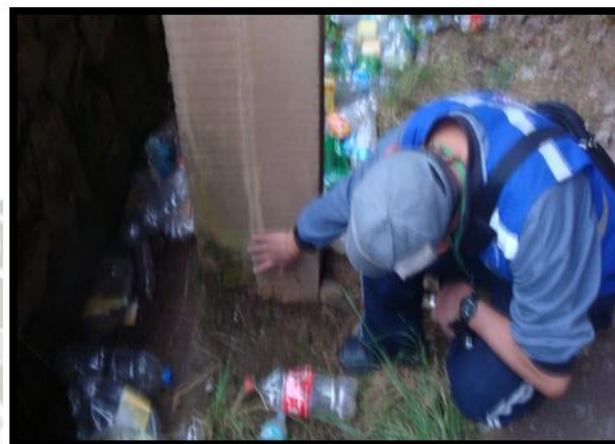
Figura 54. Columna que se encuentra debilitada por la humedad del muro contiguo.
