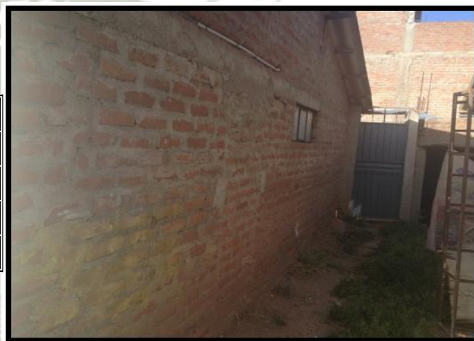
Figura 39. Vivienda modular que no presenta columnas para confinamiento.
