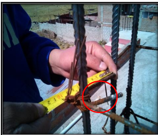
Fig. 94. Amarre deficiente en los estribos
