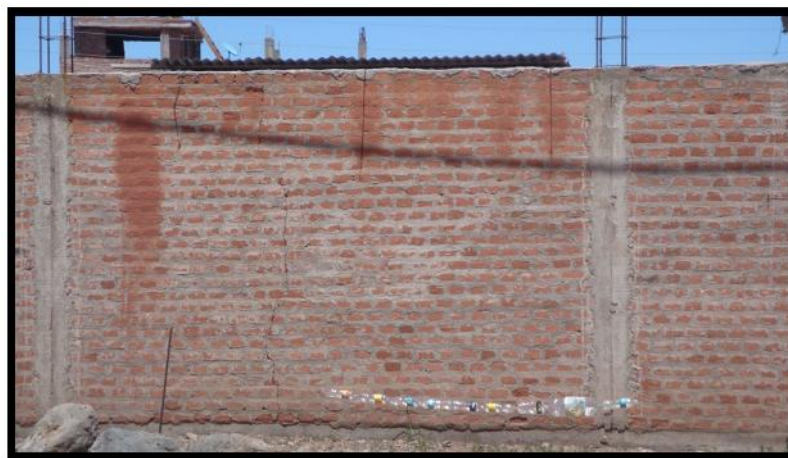
Figura 37. Ladrillos desgastados en la base y fracturados en la mitad del muro.
