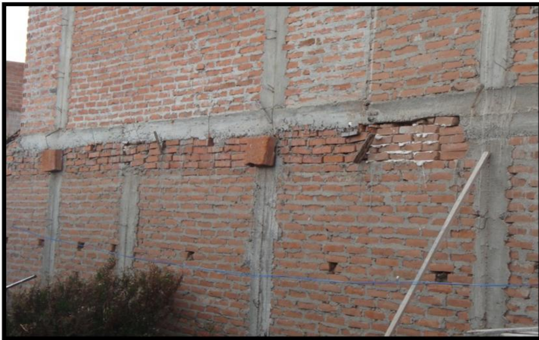
Figura 36. Ladrillos que se encuentran mal aparejados y colocados sin uniformidad
