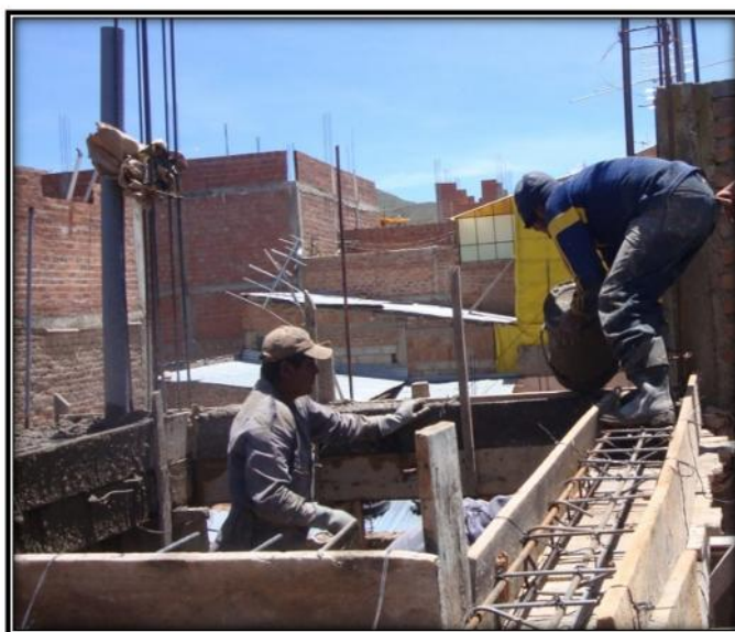
Fig. 155. Tratamiento incorrecto de una bolsa de piedra
