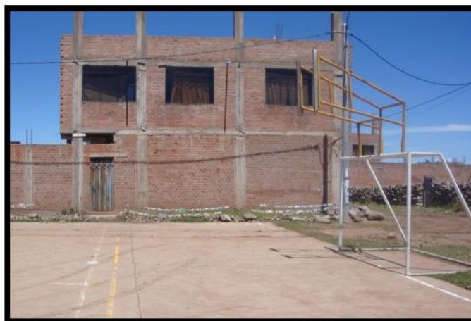
Figura 56. Discontinuidad en ventanas.
