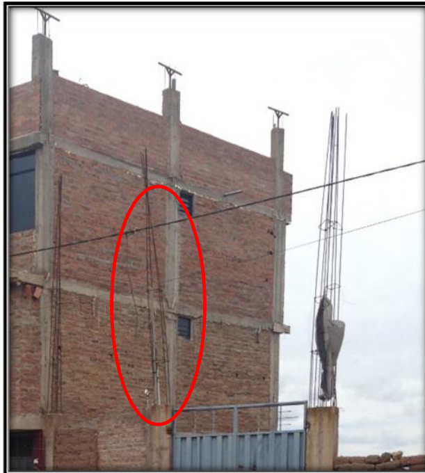
Fig. 90. Acero en estado de oxidación y corrosión
