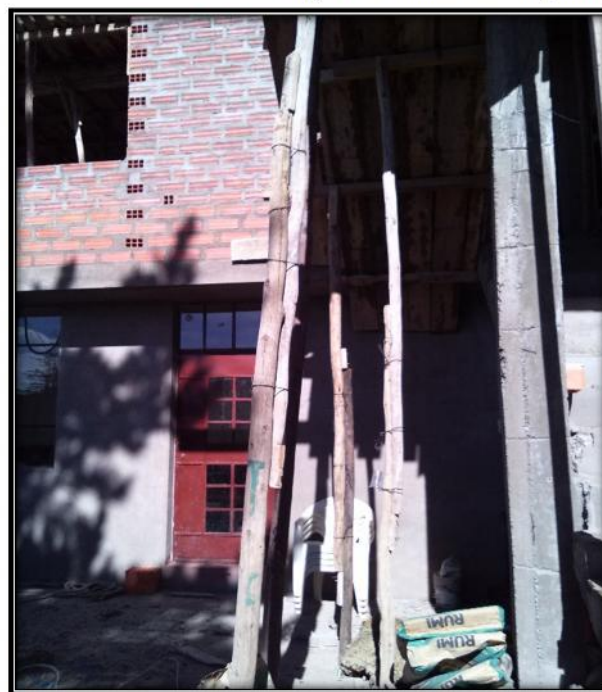
Fig. 115. Empalmes centrales inadecuados
