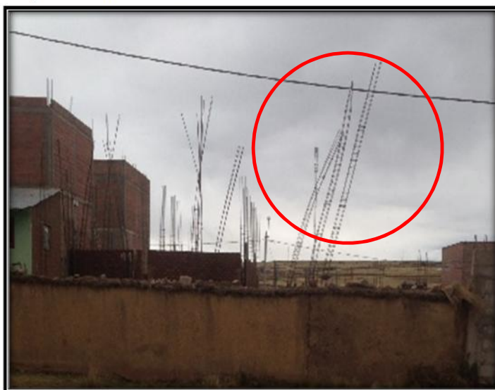
Fig. 80. Aceros deformados y doblados
