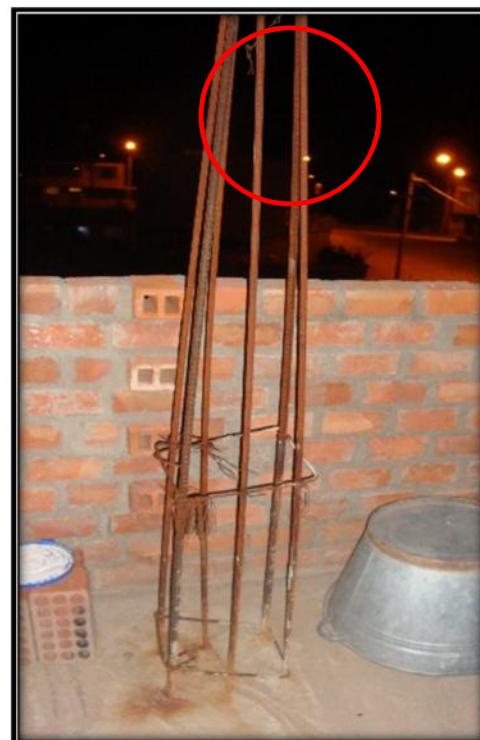
Fig. 81. Aceros expuestos y doblados
