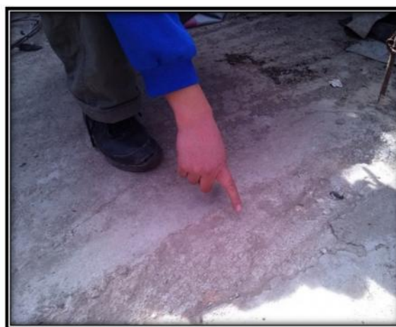
Fig. 101. Losa dañada por efectos de la helada
