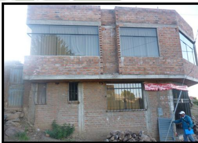
Figura 63. Vivienda que presenta picaduras después de construida. Picaduras al costado de columna para ubicar ventanas.
