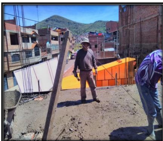
Fig. 102. Losa aligerada y concreto sin aditivos
