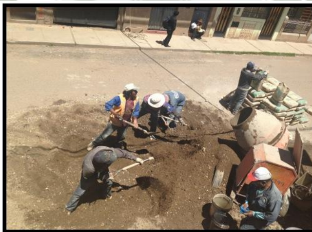
Figura 66. En esta imagen observamos muchos deficiencias y falta de concepto de seguridad en cuanto a la elaboración de concreto para losa.
