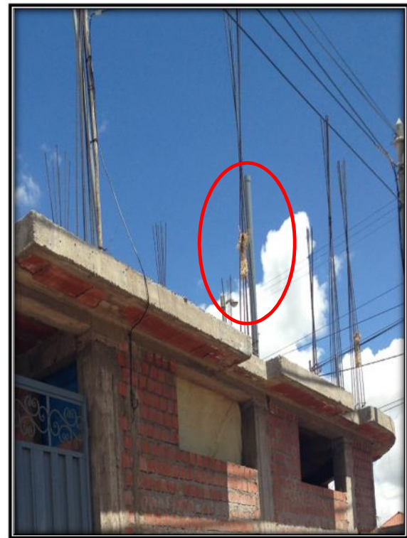
Fig. 89. Aceros sin protección propensos a corrosión
