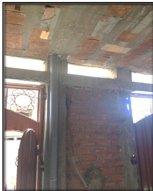
Fig. 180. Tubería de 4" que atraviesa una viga completamente
