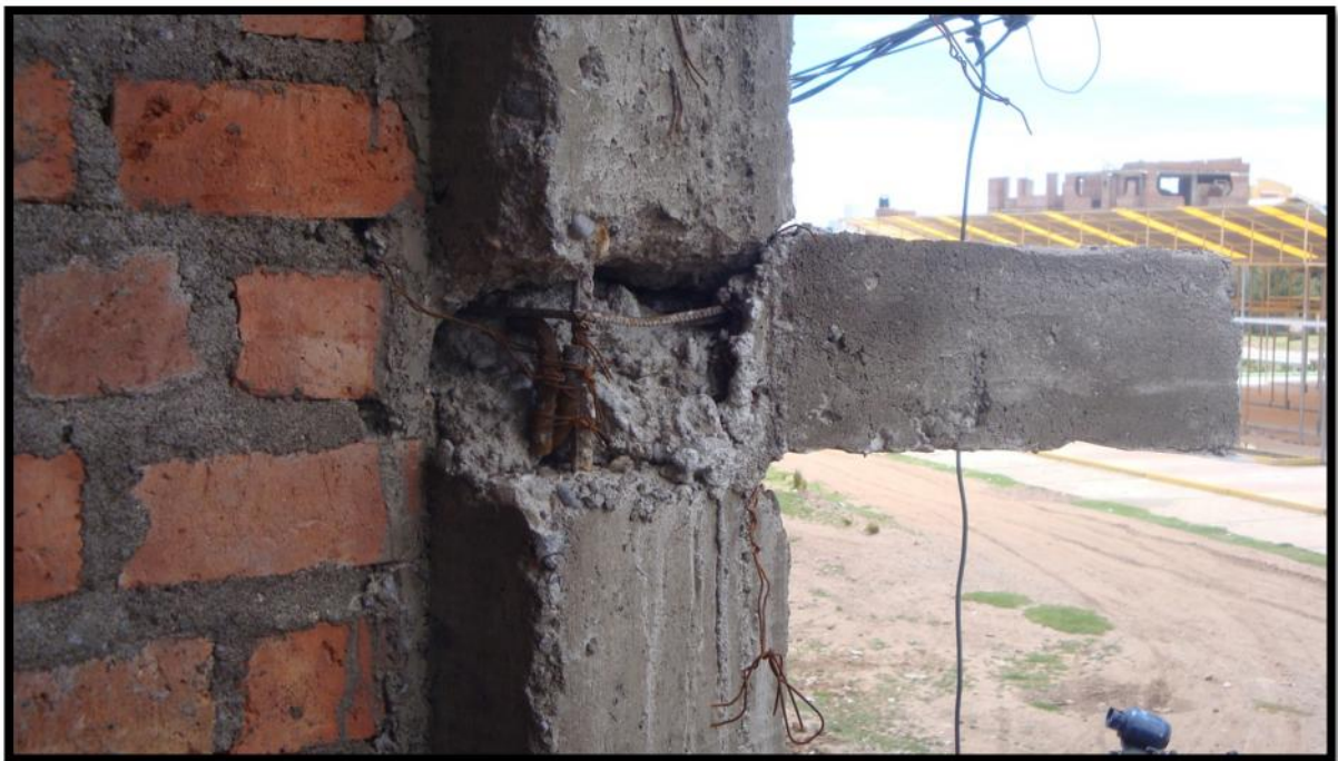
Figura 47. Acero expuesto y cangrejas en la conexión viga-columna a causa del mal proceso constructivo
