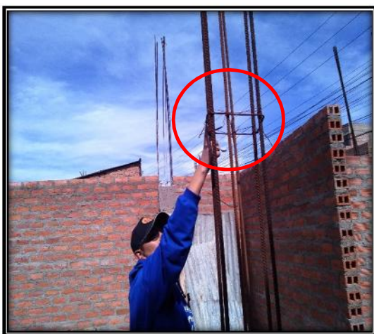
Fig. 95. Estribo colocado de manera indistinta
