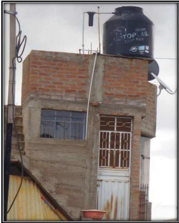
Fig. 176. Tubería seca fuera de la vivienda
