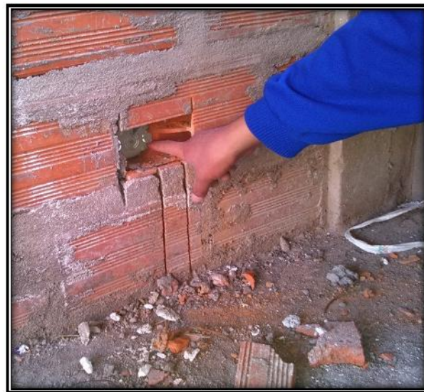
Fig. 177. Se malogra el muro por ambos lados
