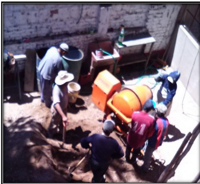
Fig. 191. Trabajadores desprovistos de casos de seguridad
