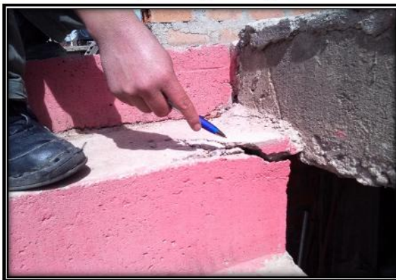
Fig. 139. Grieta peligrosa entre losa y grada
