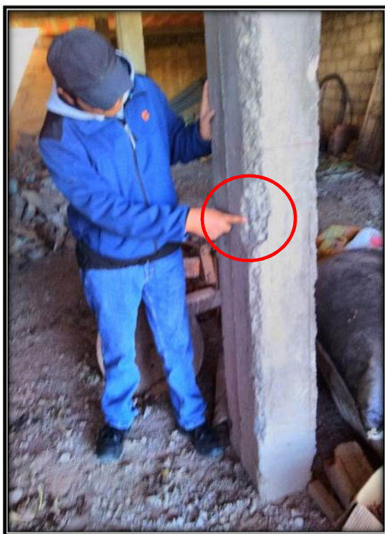
Fig. 86-a. Acero expuesto por Cangrejera
