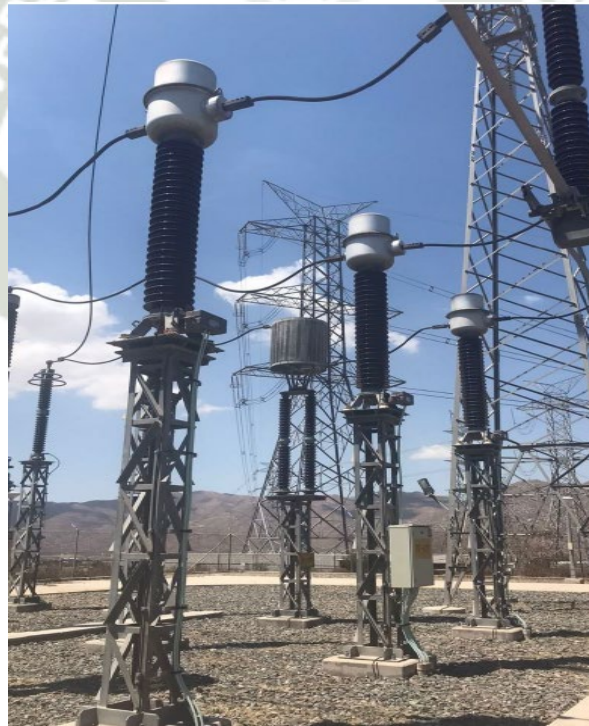
Figura 7 Transformador de Corriente
