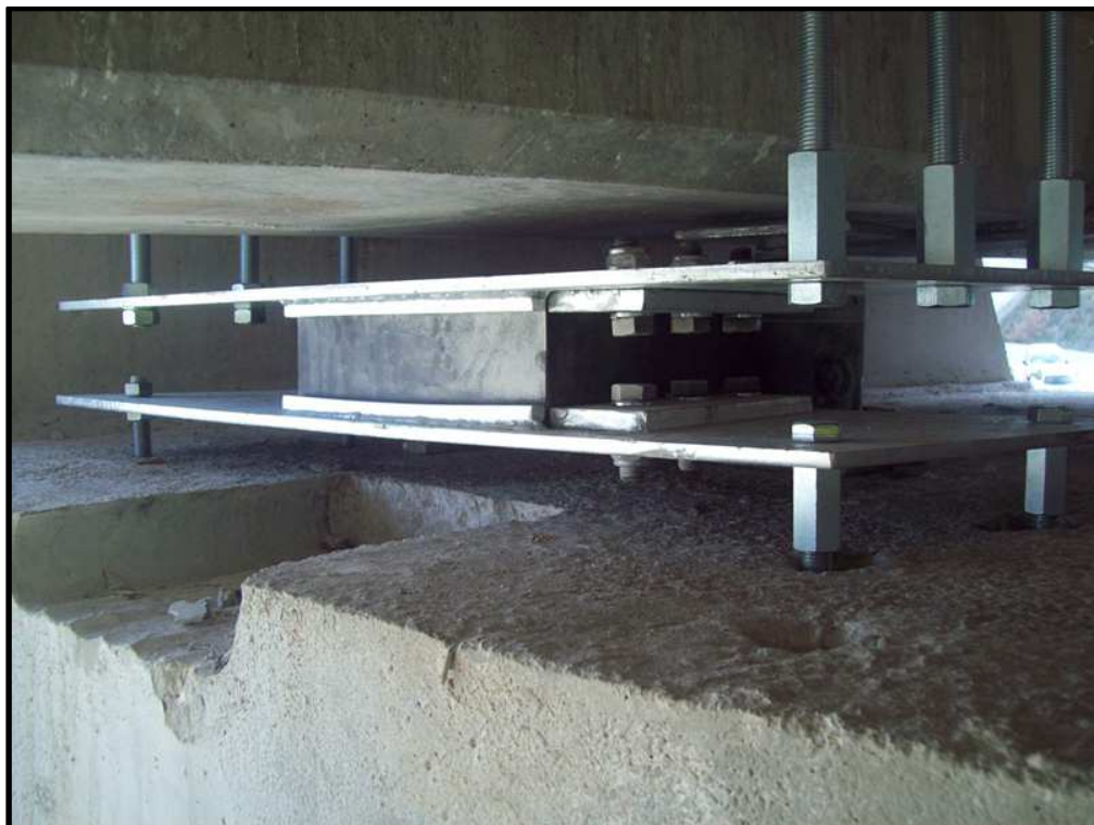
Figura 56 – Apoyo Elastomérico – Puente Añashuayco, (Fuente: www.composanpuentes.com )
