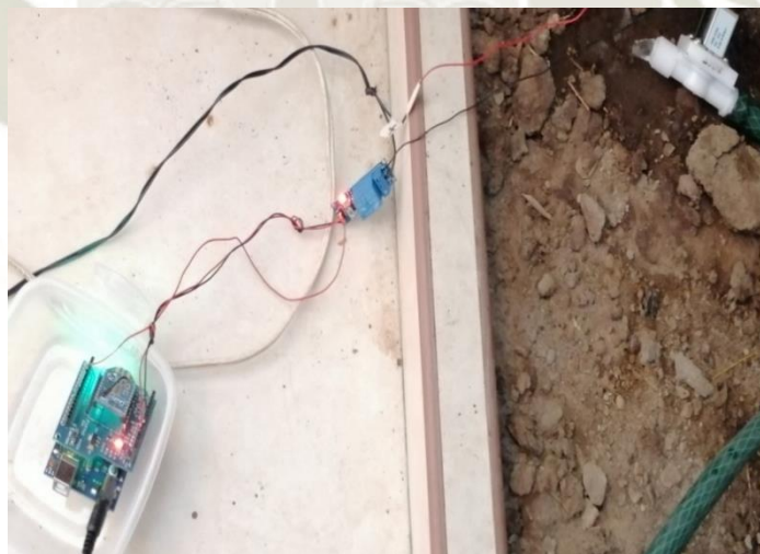
Figure 24 Modulo Actuador Activando Electrovalvula.
