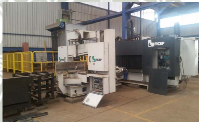
Foto N° 59: Fallas en EXCALIBUR por falta de Mantenimiento
