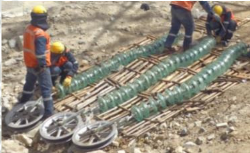
Fotografía 2.8. Uso de Aisladores de vidrio en cadenas. Fuente: Propia.
