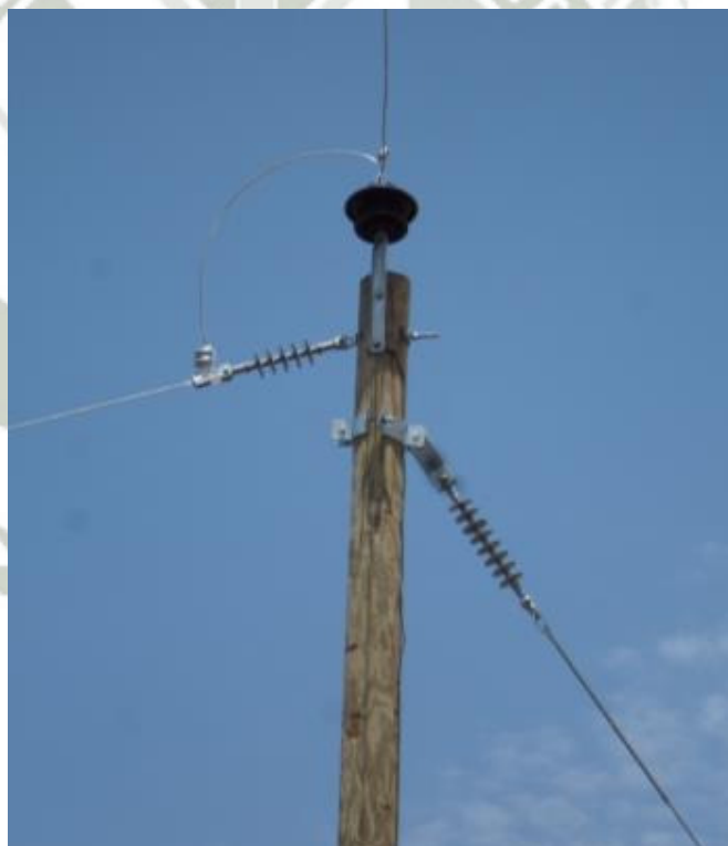
Fotografía 2.7. Uso de Aisladores Fijos en línea de media tensión. Fuente: Propia.
