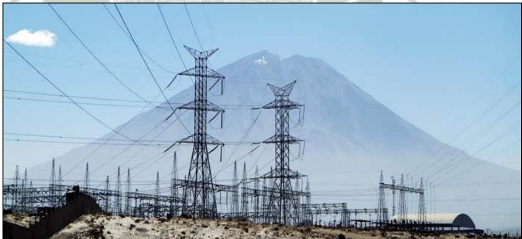
Fotografía 2.3. LT Socabaya – Cerro Verde, Arequipa. Copyright 2011 CESEL S.A.
