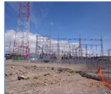
Patio de Llaves 220 kV S.E. Cotaruse
