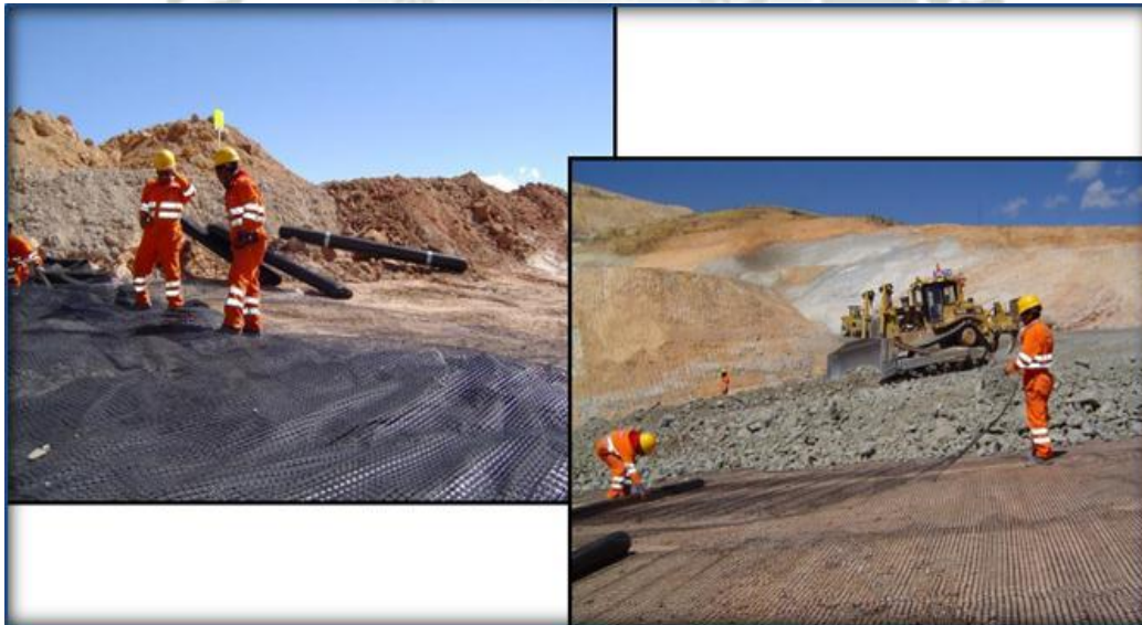
Figura 1.14: Colocación de la geomalla antes de la instalación del material de relleno.
