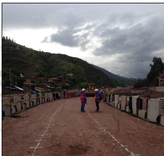
Figura 6-74. – Marcas de cal indicando la longitud del refuerzo
