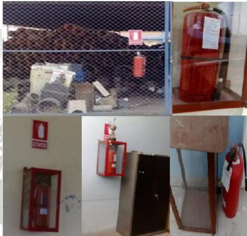
Figura 23: Extintores de la Planta
