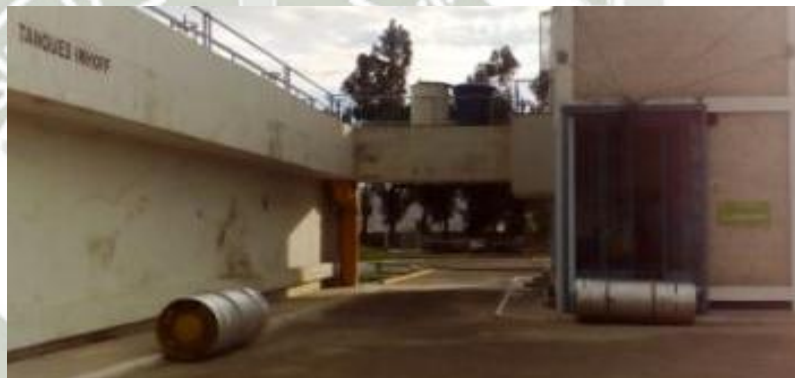
Figura 21: Tanques de cloro
