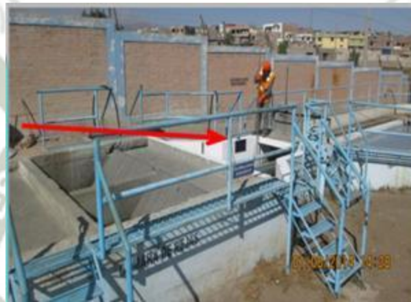
Figura 7: Medidor de Caudal
