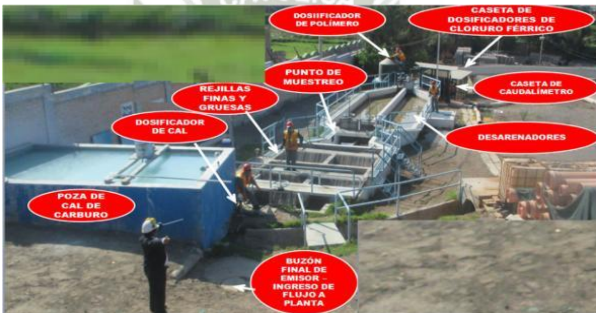
Figura 2: Vista Tratamiento Preliminar
