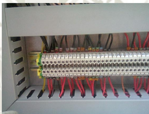
Ilustración 130. Borneras de conexionado del tablero de control.
