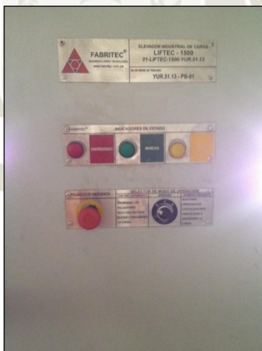
Ilustración 50 Vista frontal de tablero de control.
