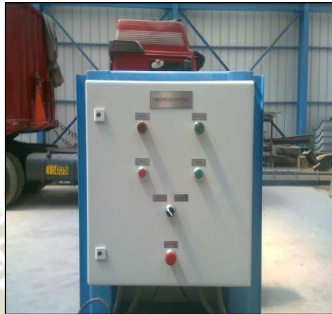
Ilustración 116. Tablero de control.
