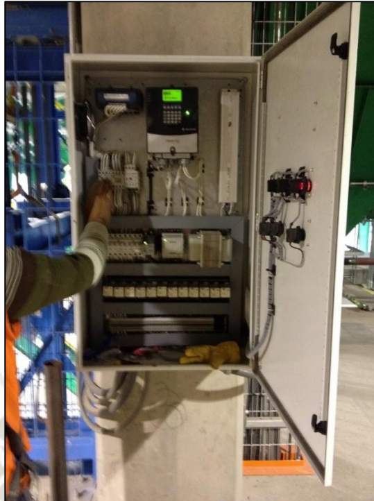
Ilustración 53. Pruebas eléctricas de control.
