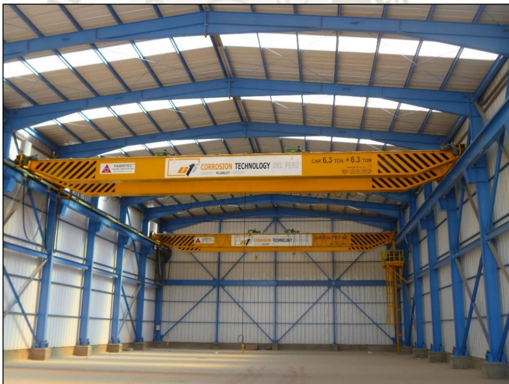
Ilustración 31. Puentes grúa en configuración tándem.
