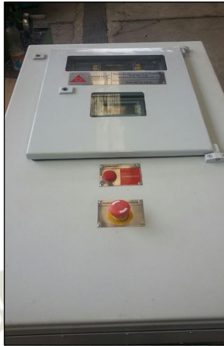
Ilustración 102 Tablero de control terminado en taller.
