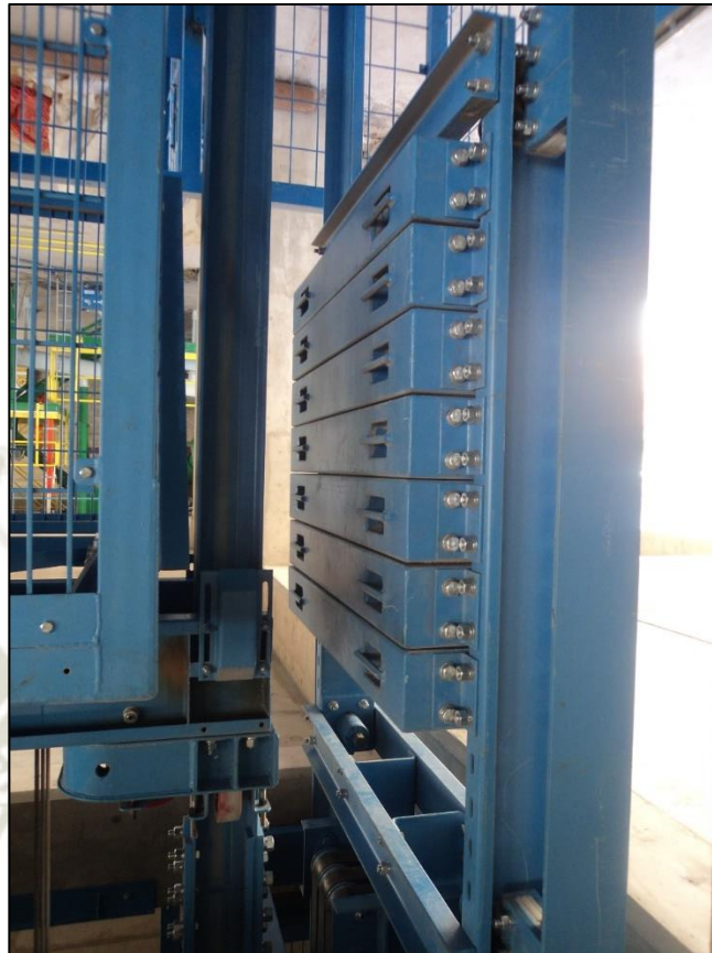
Ilustración 63. Contrapesos de concreto.
