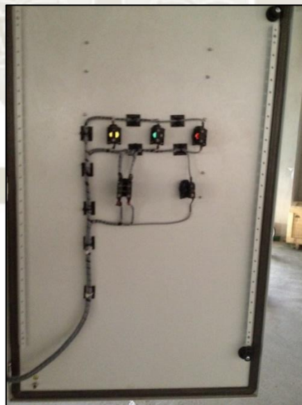
Ilustración 52. Cableado de panel frontal del tablero.
