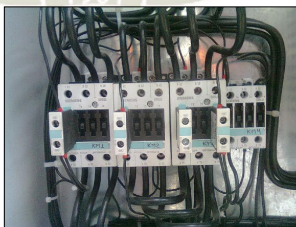
Ilustración 140. Contactores de fuerza.
