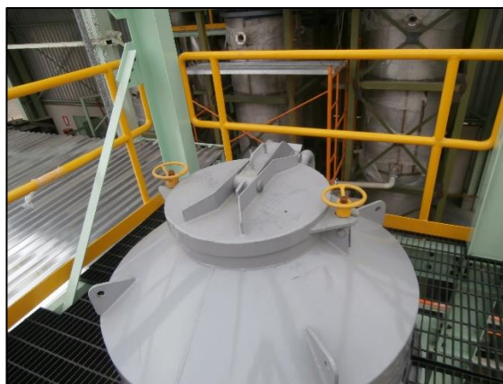
Ilustración 104 Tolva de almacenamiento de material.
