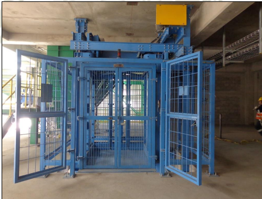
Ilustración 68. Vista frontal cabina con las rejas cerradas.
