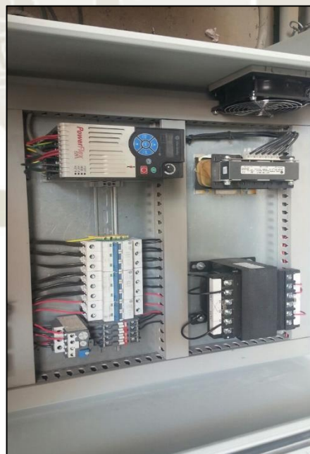
Ilustración 103 Tablero del variador de velocidad terminado.
