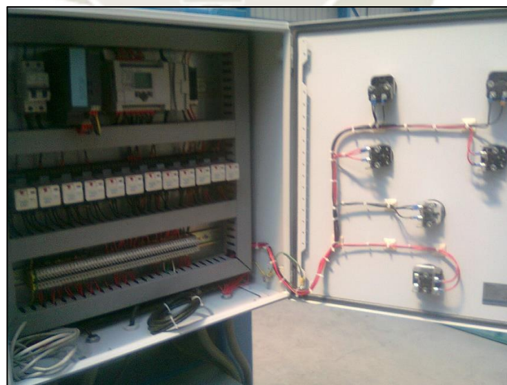
Ilustración 128. Tablero de control del sistema enrollador
