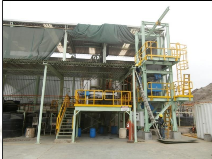
Ilustración 112 Vista Frontal de la planta piloto en las instalaciones de Buenaventura.
