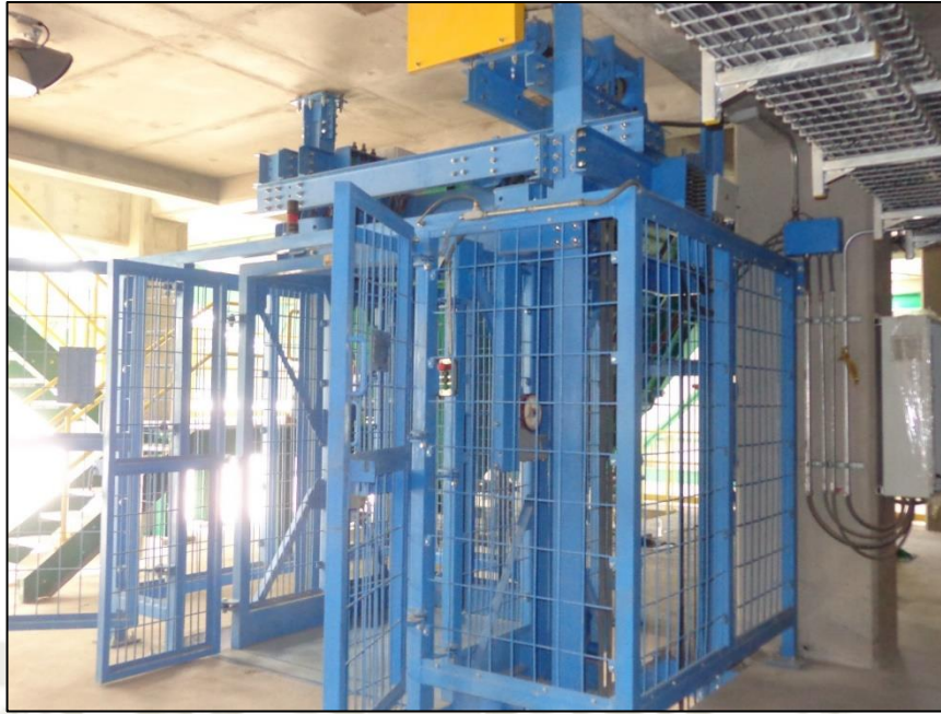
Ilustración 67. Vista lateral elevador de carga.
