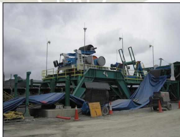
Ilustración 114 Sistema de tracción temporal en planta concentradora.
