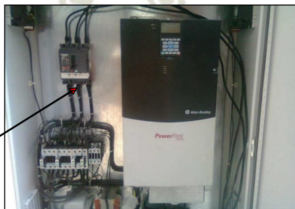
Ilustración 119. Interior del tablero VFD.
