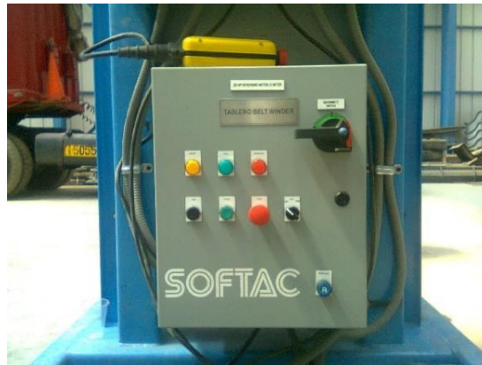
Ilustración 150. Tablero de fuerza del equipo enrollador de faja.
