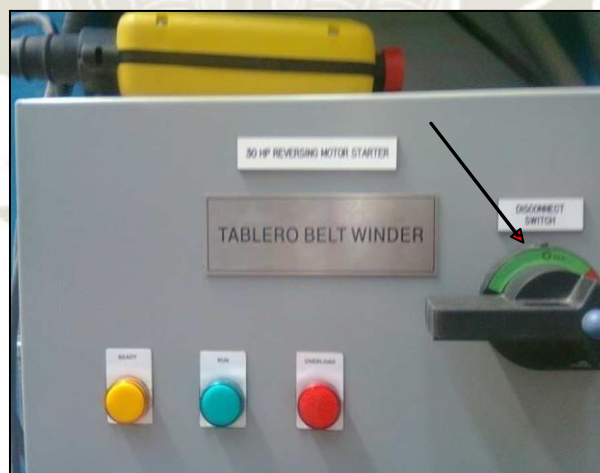
Ilustración 123. Tablero de fuerza del Belt Winder.
