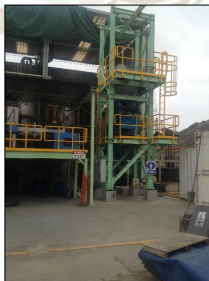
Ilustración 96 Planta piloto después del montaje.
