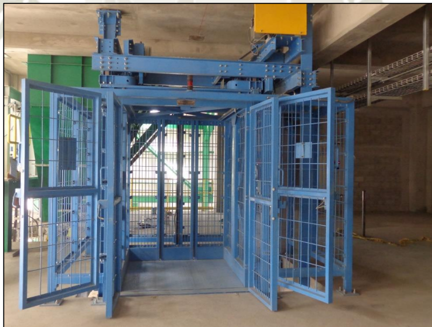
Ilustración 66. Vista frontal segundo nivel elevador de carga.
