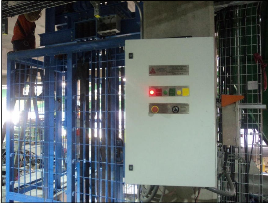
Ilustración 75. Tablero de control operativo
