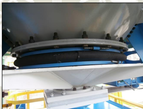
Ilustración 105 Chute de transferencia de material.
