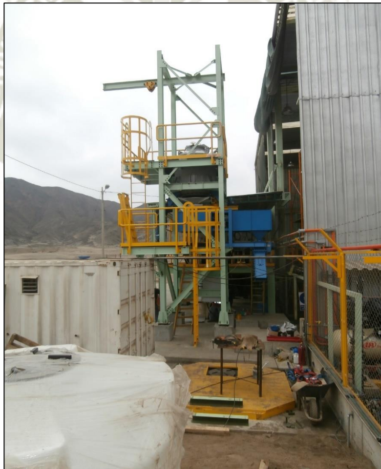
Ilustración 111 Vista lateral de la planta piloto ya instalada.
