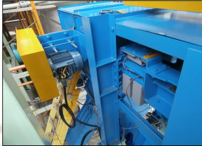
Ilustración 107 Accionamiento de la faja transportadora.
