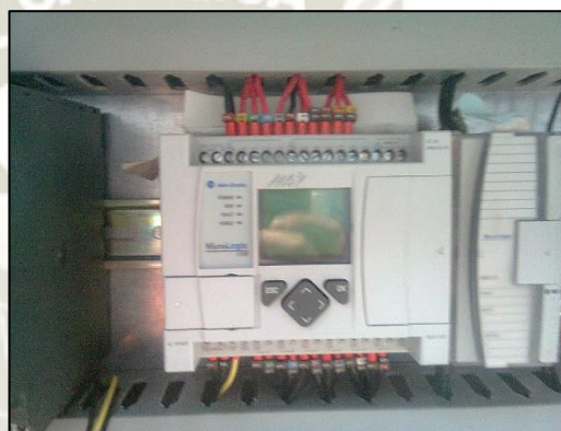
Ilustración 133. PLC MicroLogix 1100 Marca Allen Bradley.
