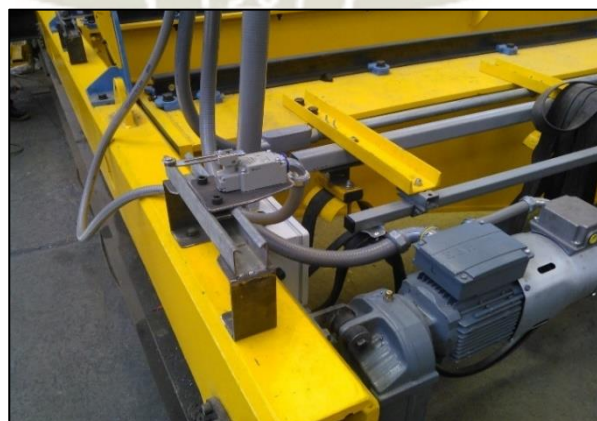
Ilustración 21. Sensor final de carrera y motorreductor de traslación.
