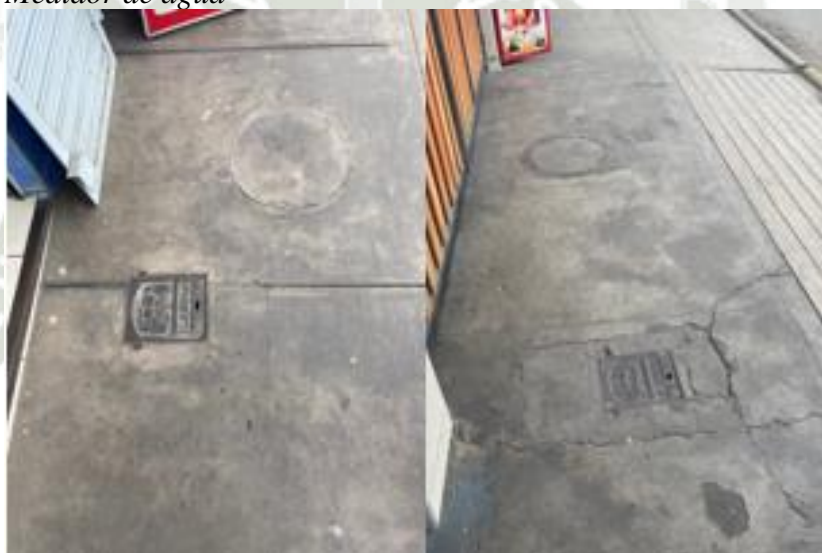
Figura 38 Medidor de agua
