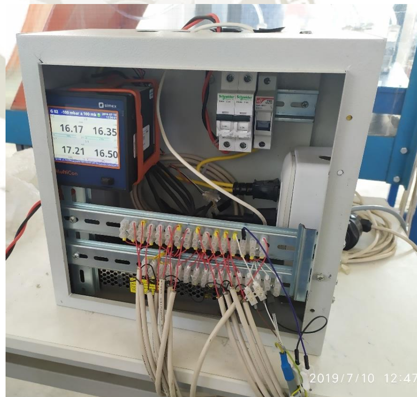
Figura 4-14. Controlador MultiCon CMC-141.
