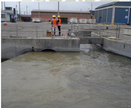
Dos colectores: Interceptor Norte y Colector Comas-Chillón recolecta desagues de 27 distritos.
