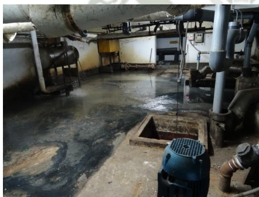
Panorama del Tanque séptico que recolecta desagüe de Hospitalización y otros. Punto 2
