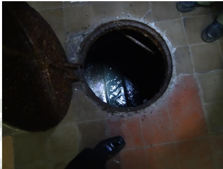
Buzón que recolecta desagües de la zona Hospitalización y los Pabellones A y B
