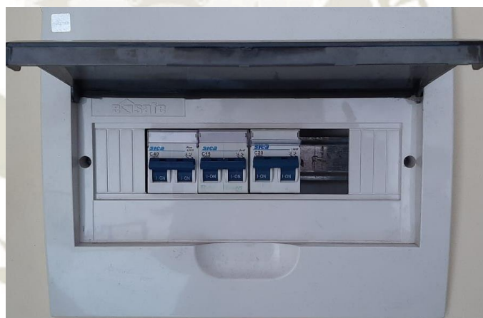
Figura 5.11 Tablero eléctrico principal de una vivienda
