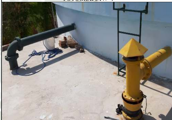
TUBERÍAS DE INGRESO Y REBOSE DE RESERVORIO R-32
