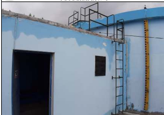
REGLA PARA MEDIR NIVEL DE AGUA EN RESERVORIO R-32.
