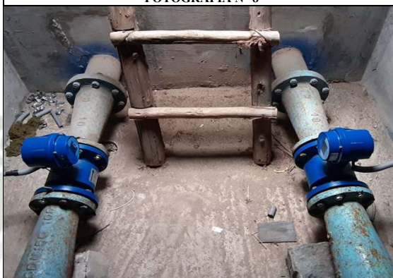
TUBERÍAS DE SALIDA DE RESERVORIO R-32 (PAMPA Y PUEBLO).
