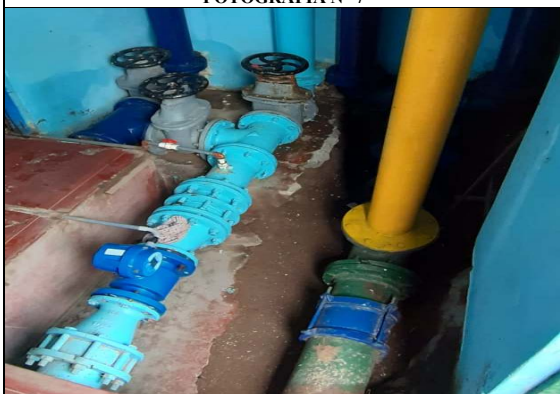
CÁMARA DE VÁLVULAS DE RESERVORIO R-20.
