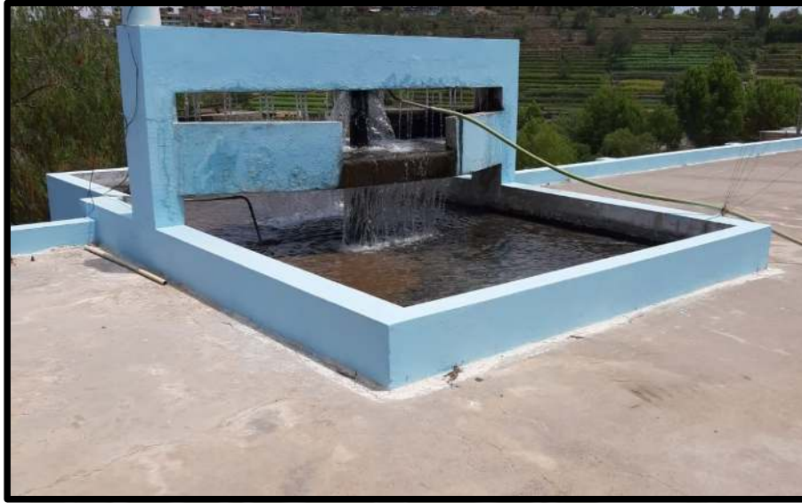
Figura 13. Aireador a la entrada del R-20. Fuente: Elaboración Propia
