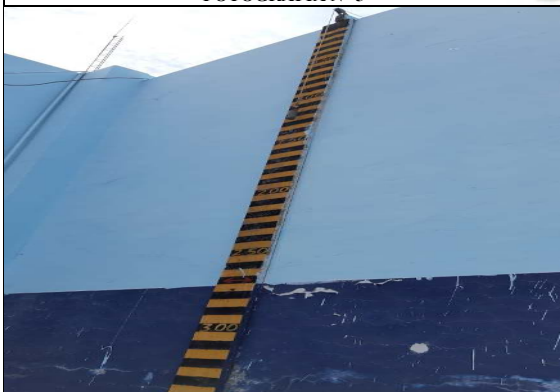
REGLA PARA MEDIR NIVEL DE AGUA EN RESERVORIO R-20.
