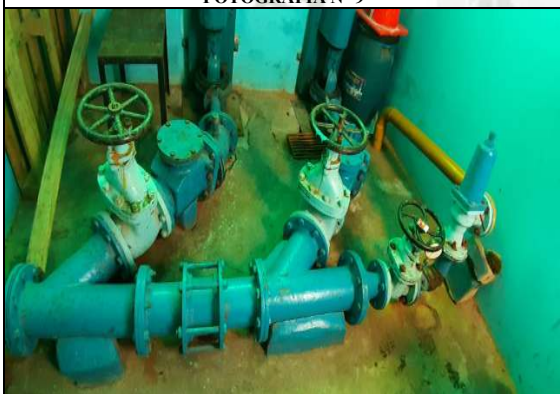
CÁMARA DE IMPULSIÓN DEL MANANTIAL DE SABANDÍA.
