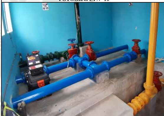
CÁMARA DE VÁLVULAS DE RESERVORIO R-32.
