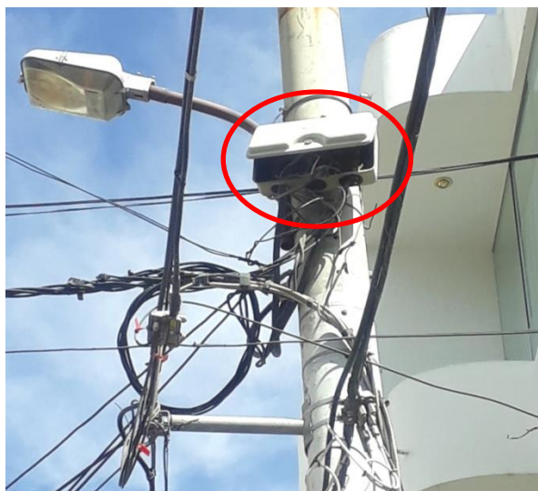
Foto 31: Caja de derivación de acometidas abierta
