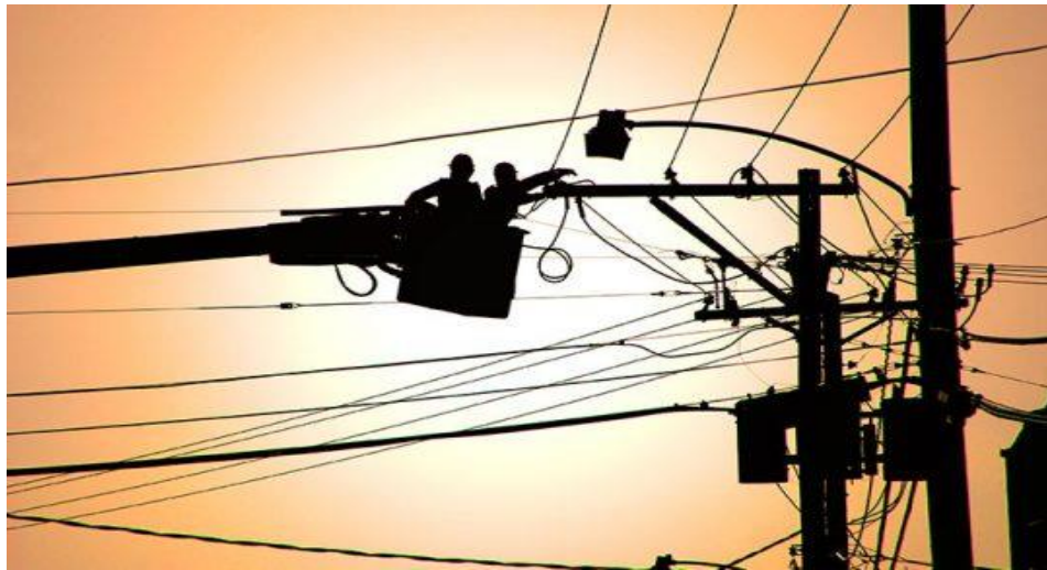
Foto 3: Redes de Distribución Eléctrica
