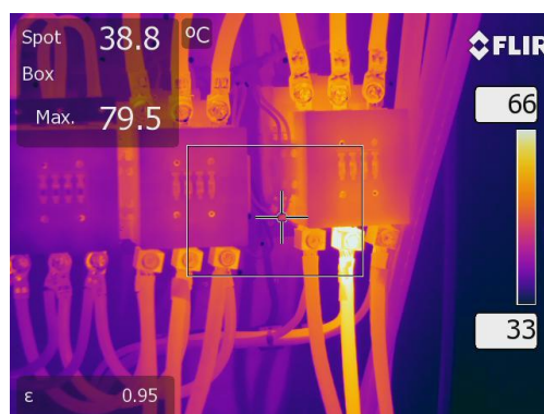
Foto 33: Termografía Falso Contacto
