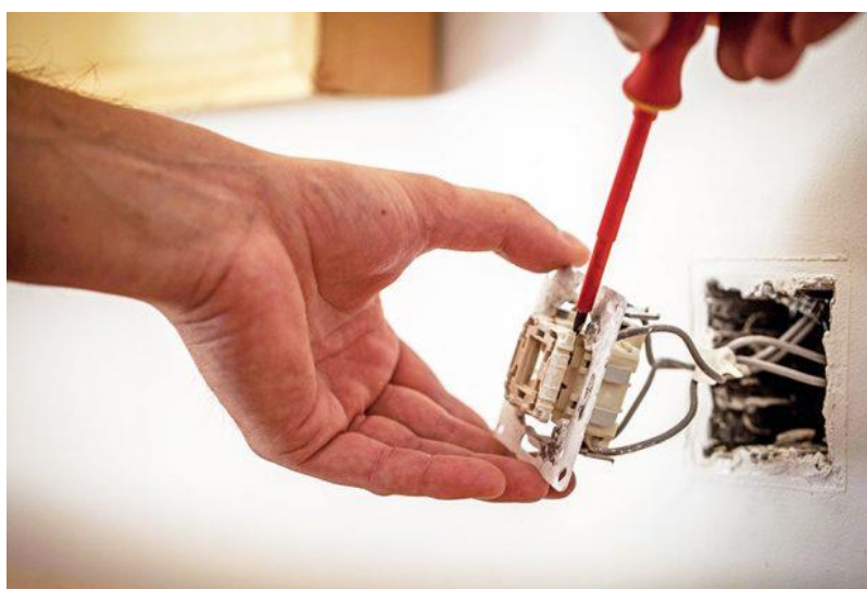
Foto 18: Desperfecto Eléctrico Interno
