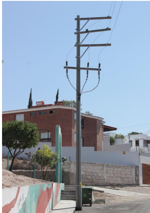
Foto 5: Estructura de Media Tensión
