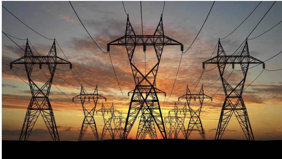
Foto 2: Torres de transmisión eléctrica
