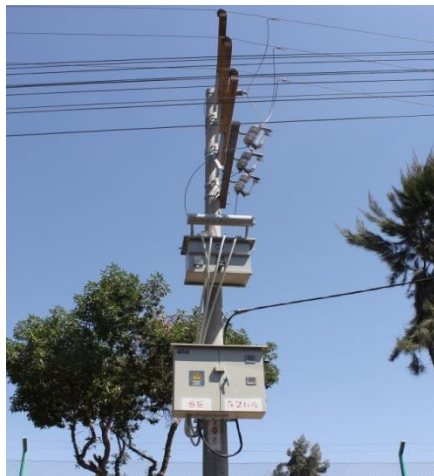
Foto 8: Subestación de distribución (SED)
