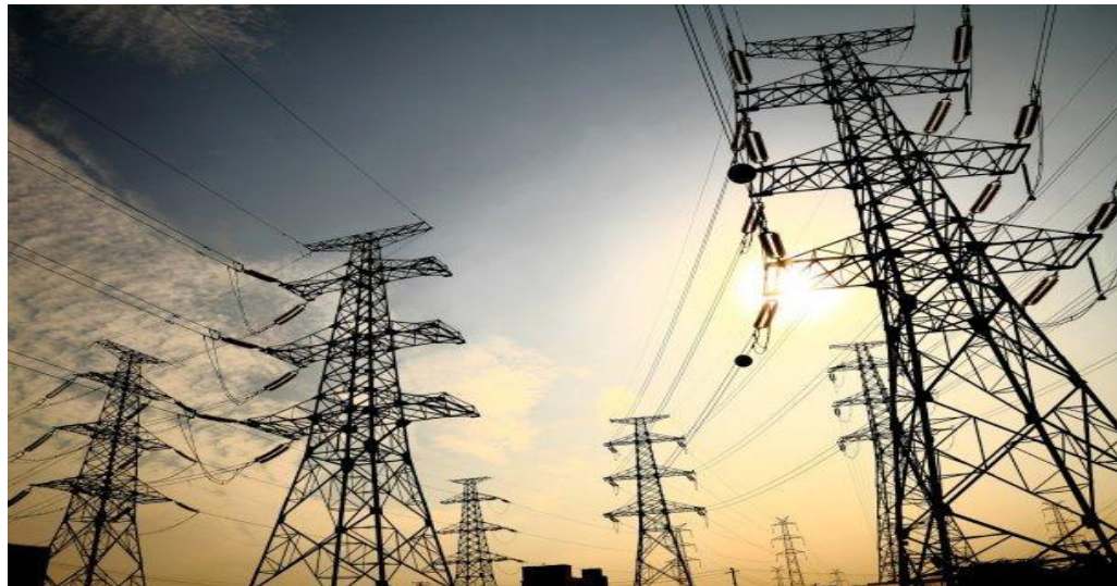
Foto 4: Torre de Alta Tensión
