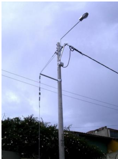
Foto 6: Poste de Baja Tensión
