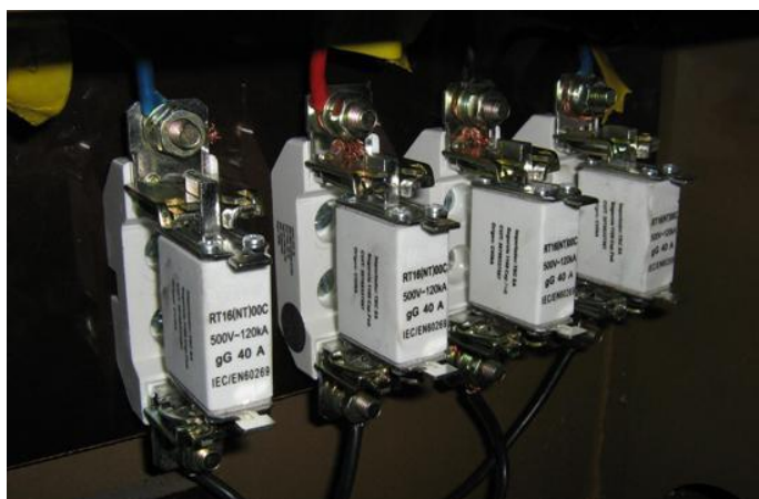
Foto 26: Base portafusibles y fusibles
