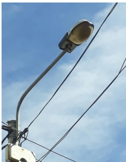
Foto 21: Difusor en mal estado
