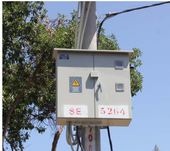
Foto 9: Tablero de Distribución
