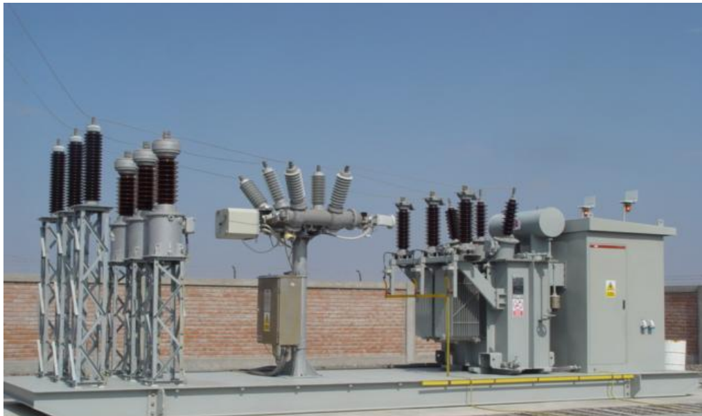
Foto 17: Subestación de Transformación
