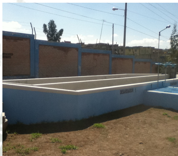
Figura 19: Desarenador I – Planta de Chilpinilla - Vista Frontal Fuente: Fotografía propia
