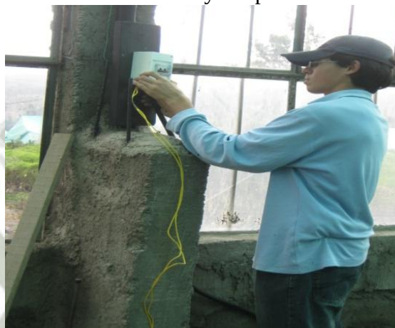
Fotografía N°25 Instalación luz y temporizador
