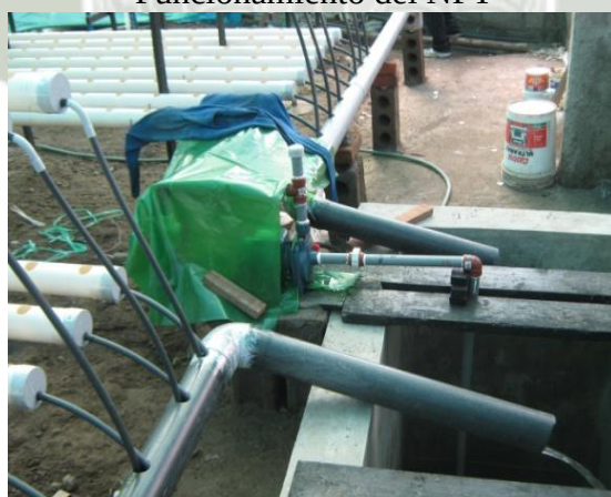
Fotografía N°26 Funcionamiento del NFT
