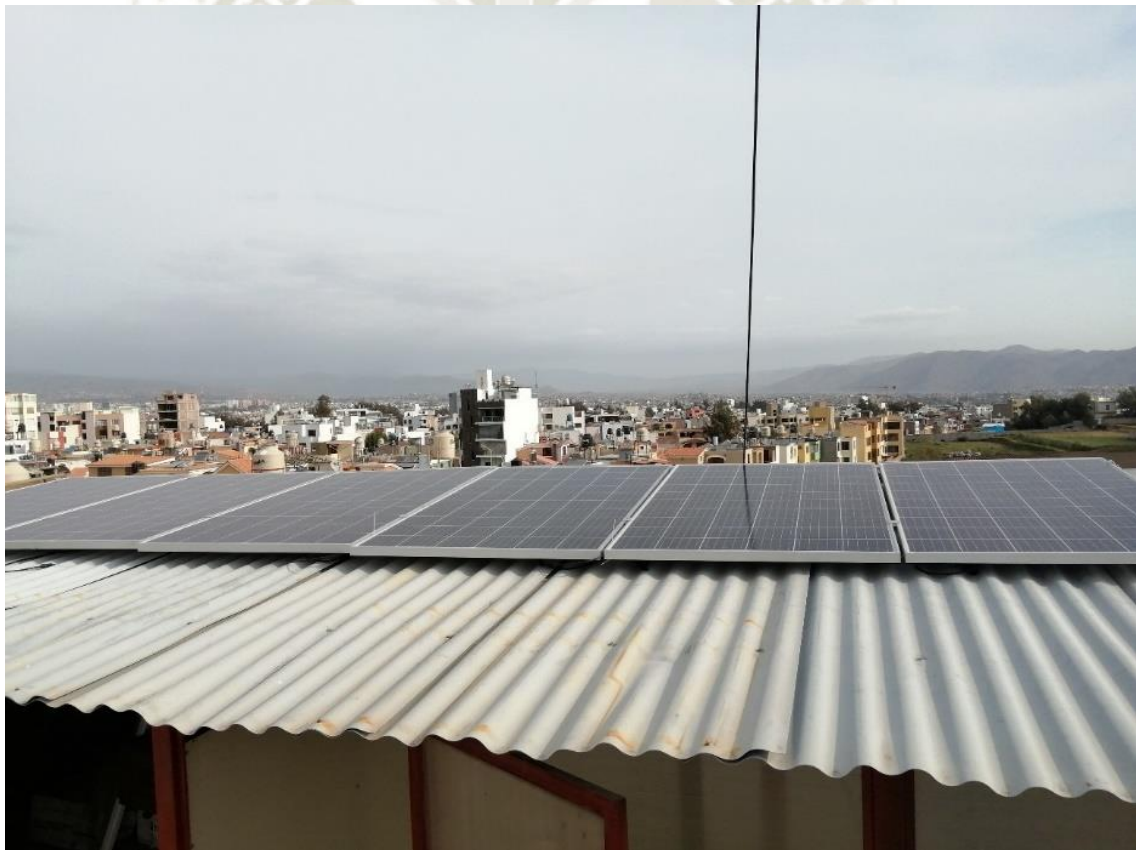
Figura 31 Paneles Fotovoltaicos Instalados
