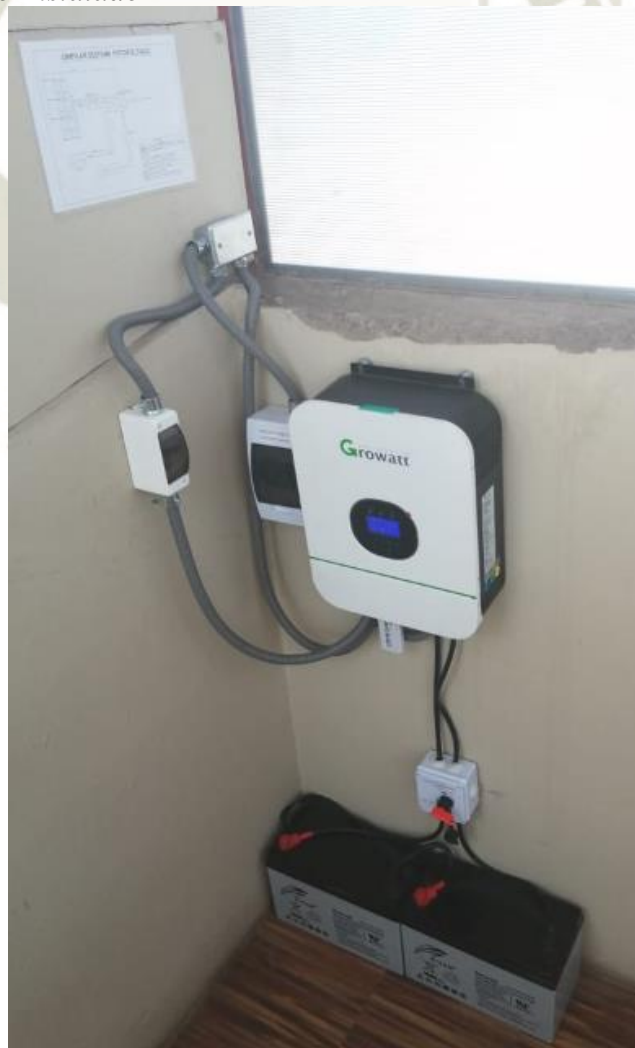
Figura 32 Sistema Fotovoltaico Instalado
