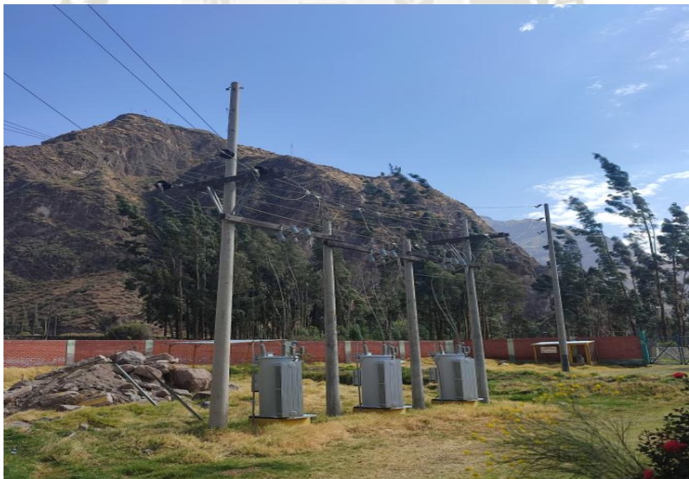
Figura N° 43. Imagen de Transformadores Elevadores de Tensión 22.9 KV para el distrito de Cotahuasi (imagen real).
