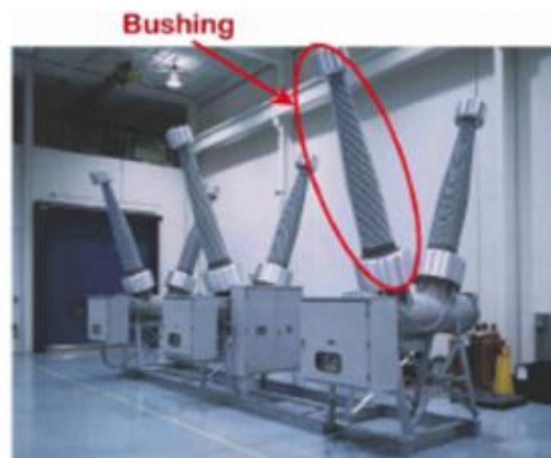
Figura N° 1. Aislamiento Externo de transformador.
