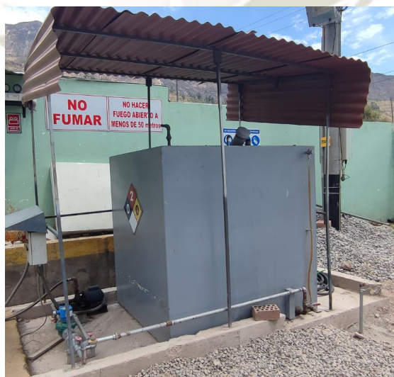
Figura N° 57. Tanque de reserva para grupos electrógenos.
