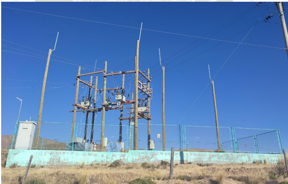
Figura N° 41. Patio de Maniobras de Recloser's en 22.9 KV (imagen real)
