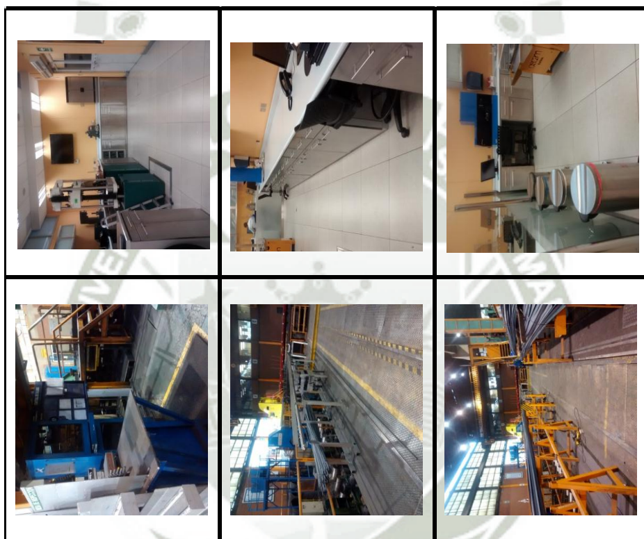
Figura N° 7: REGISTRO FOTOGRAFICO ESTADO ACTUAL DE LAS ZONAS (PLANTA DE CONTROL DE CALIDAD, LABORATORIO CONTROL DE CALIDAD)
