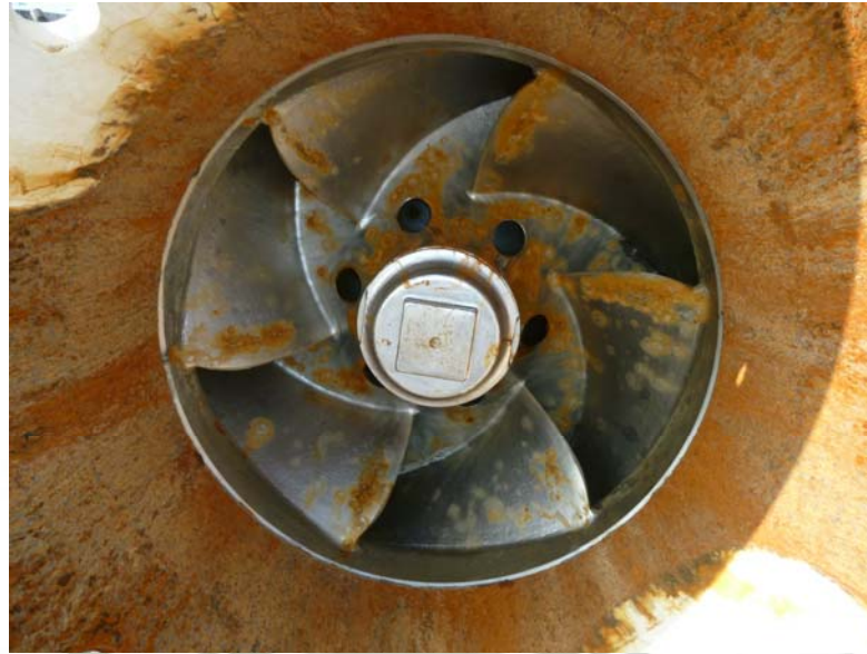
Figura 3.7. Foto de la carcasa e impelente con corrosión
