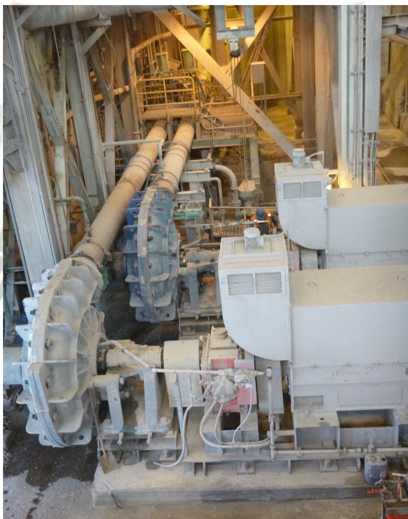
Fig. 6.6. Vista general de las tuberías de descarga de 22"
