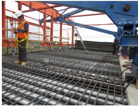
Foto 09: Fuente Arch. Fotográfico P. Chilina – Acero y Ductos PT en Losa Sup.
