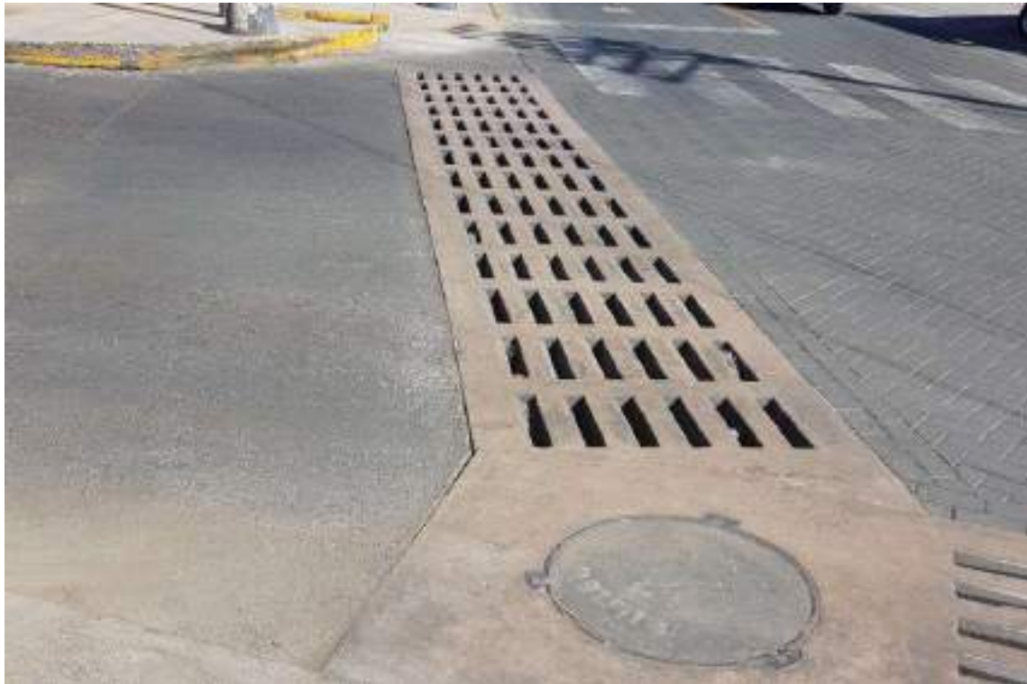
Ilustración 19: Sumidero típico en Arequipa (Elaboración Propia, 2017)
