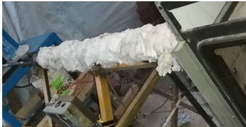
Figura 16 Fibra cerámica como aislante de calor (Fuente propia)
