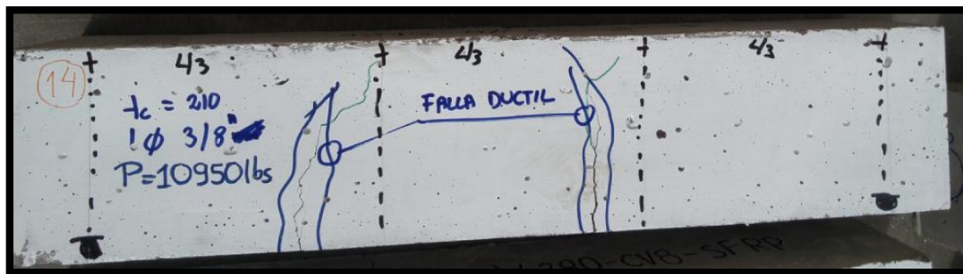
Figura 5.1 Viga #14 después del ensayo.
