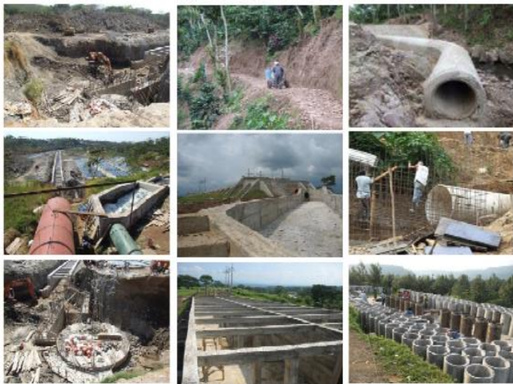
Figura N° 18: Conducción del agua.
