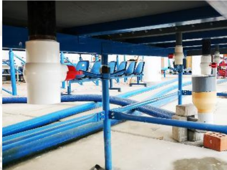
Fotografía 3. Tuberías de salida de agua
