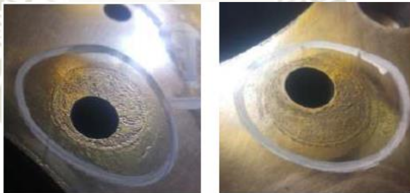
Imagen N° 73: Corrosión en los pases de agua
