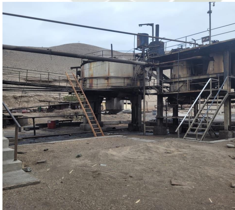
Figura 12 Imagen clarificador principal proceso de Clarificación
