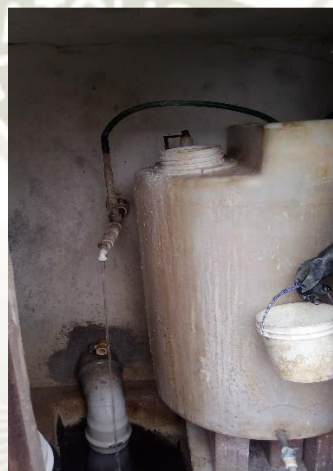
Caseta de cloración por dentro
