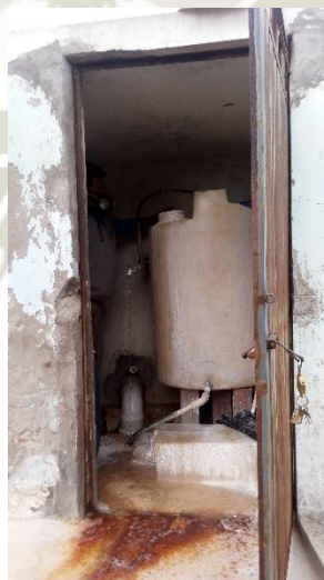
Caseta de cloración por dentro
