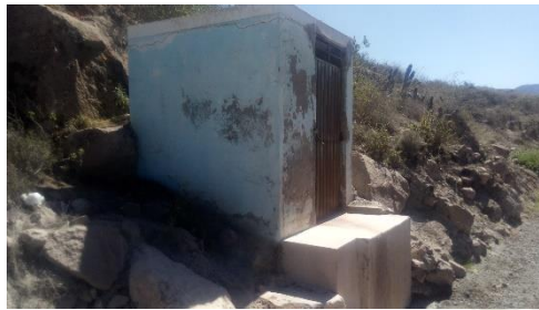
Caseta de cloración externamente
