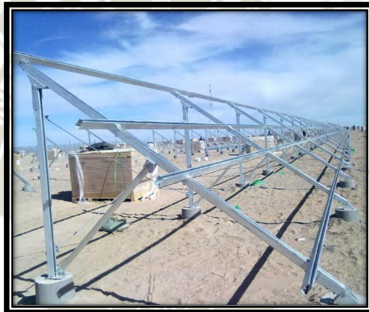
Ilustración 53: Soporte estructural solar
